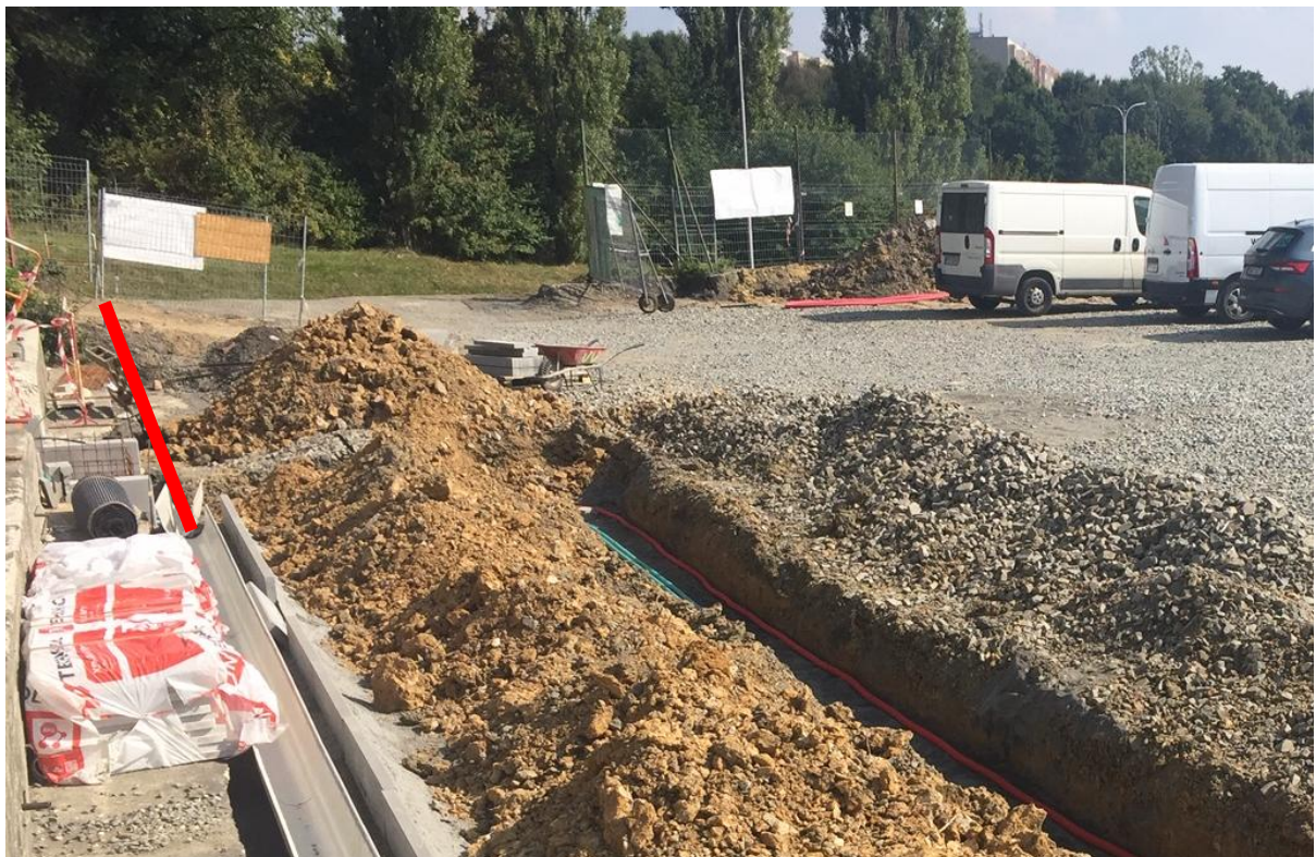
Odvodňovací žlab - doplnění na SV straně
