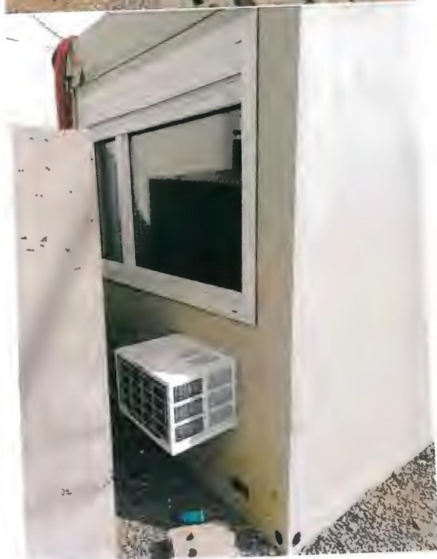
Buňky BTAS po osazení klimatizačních jednotek
