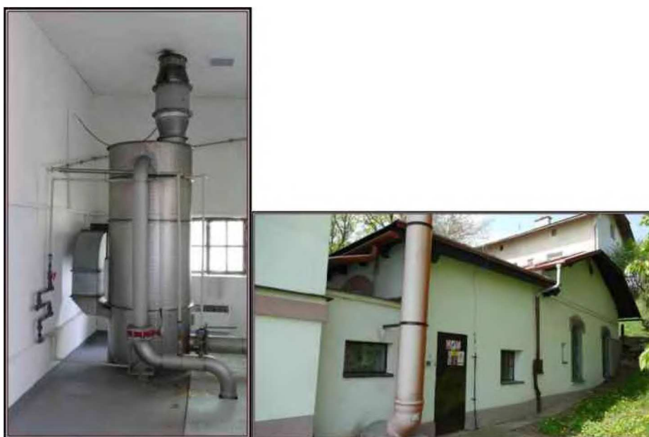
Vstup do chlorovny a chlorovna ČS Kostelec
