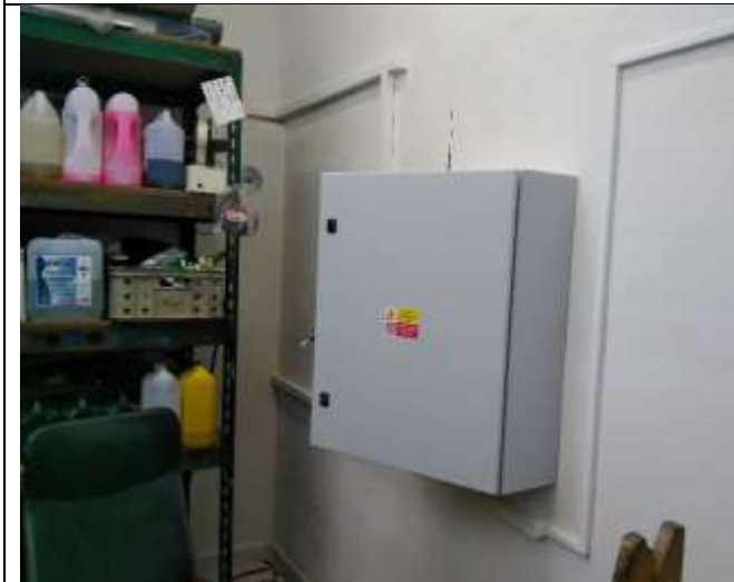
Obr. EST.16-3 – umístění rozvaděče sirény na zdi ve skladu
