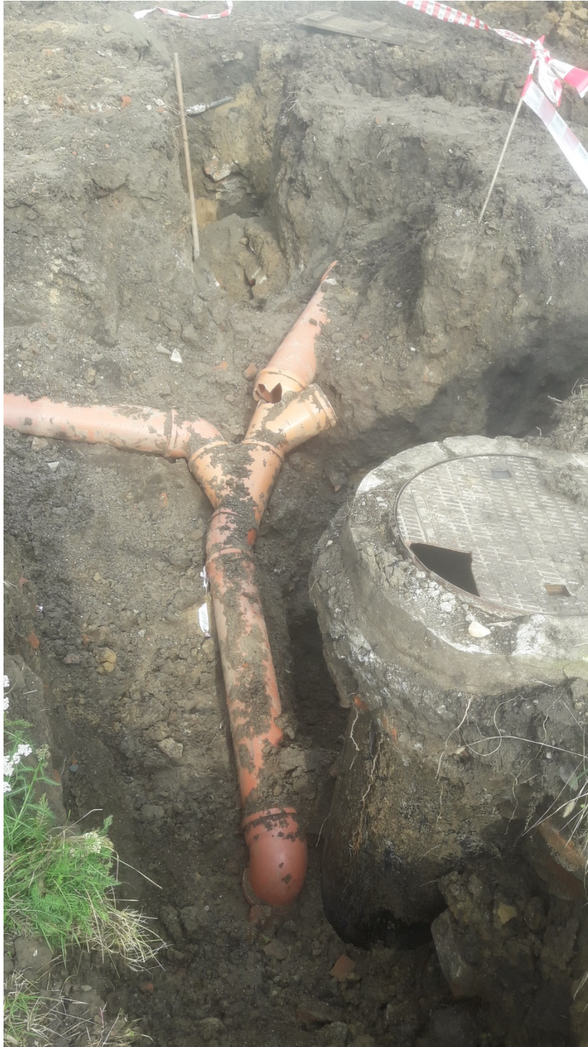
Z 34 (stávající kanalizace – poškození)
