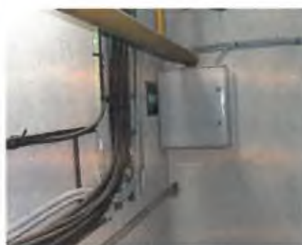
plastový rozvaděč cca 500x430x210mm
