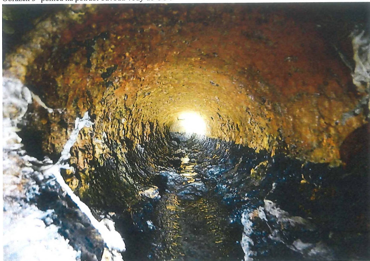
Obrázek 3- pohled na potrubí odvodu vody do ČOV
