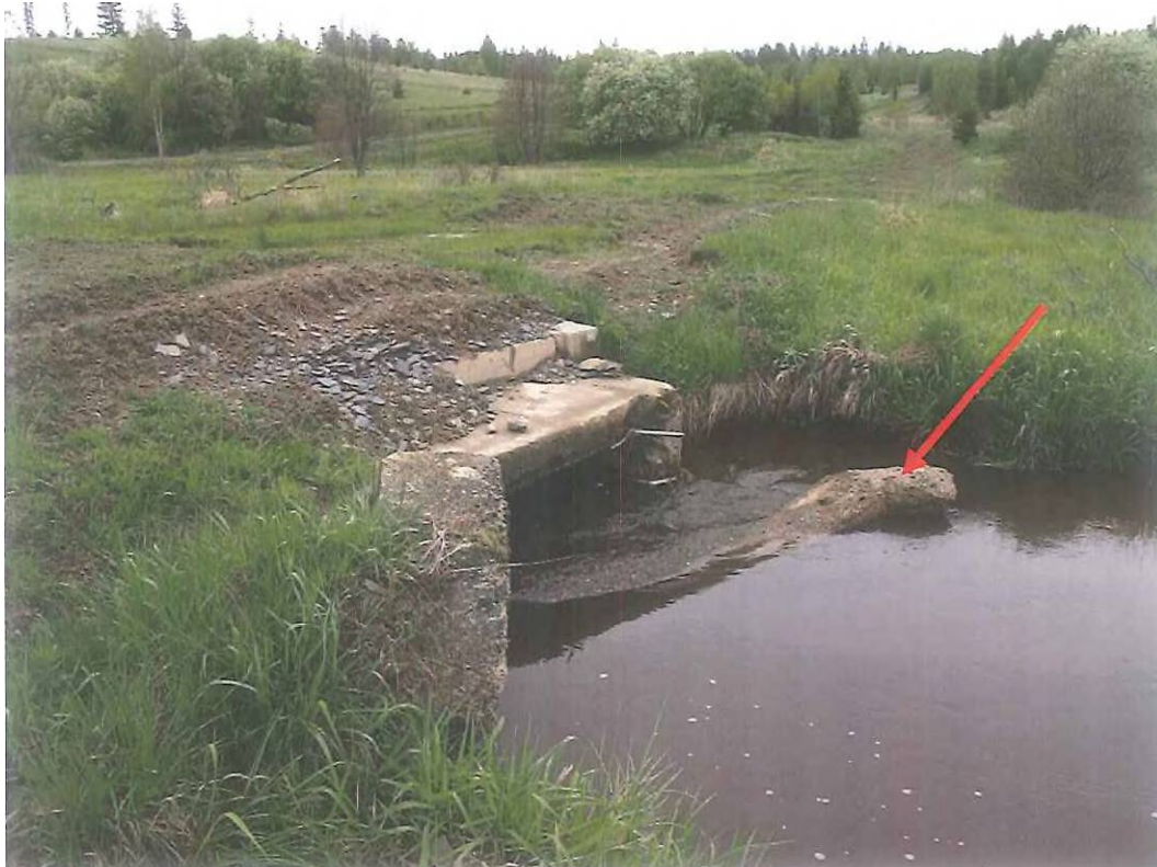
Foto 4 Plazský potok - stržené čelo propustku snižuje jeho průtočnou kapacitu.
