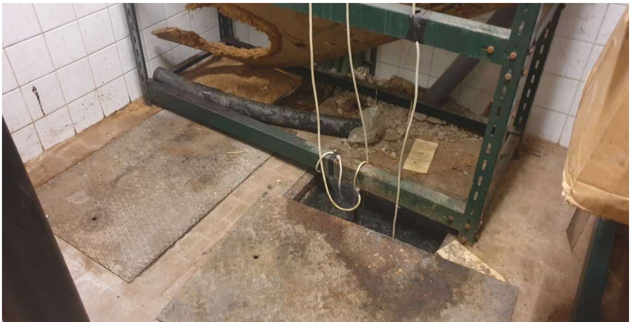
Obr. 13 Aktuální stav - 5.PP - čerpací stanice splaškové kanalizace (havarijný stav)
