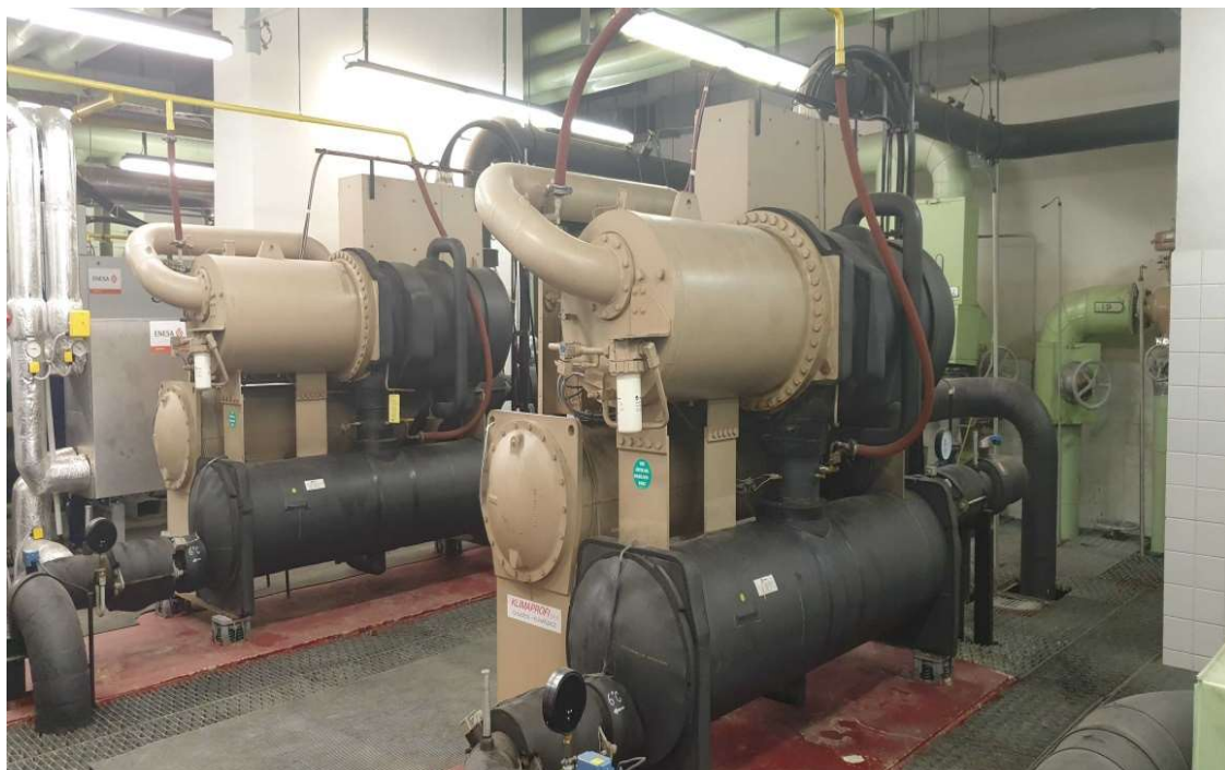
Obr. 19 Strojovna chlazení pro celá areál Národního divadla – Dva zdroje chladu TRANE RTHA 450 z roku 1995
