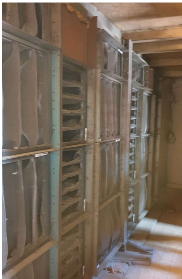
Obr. 3 Nasávací objekt – aktuální stav filtrů pro centrální nasávání vzduchu
