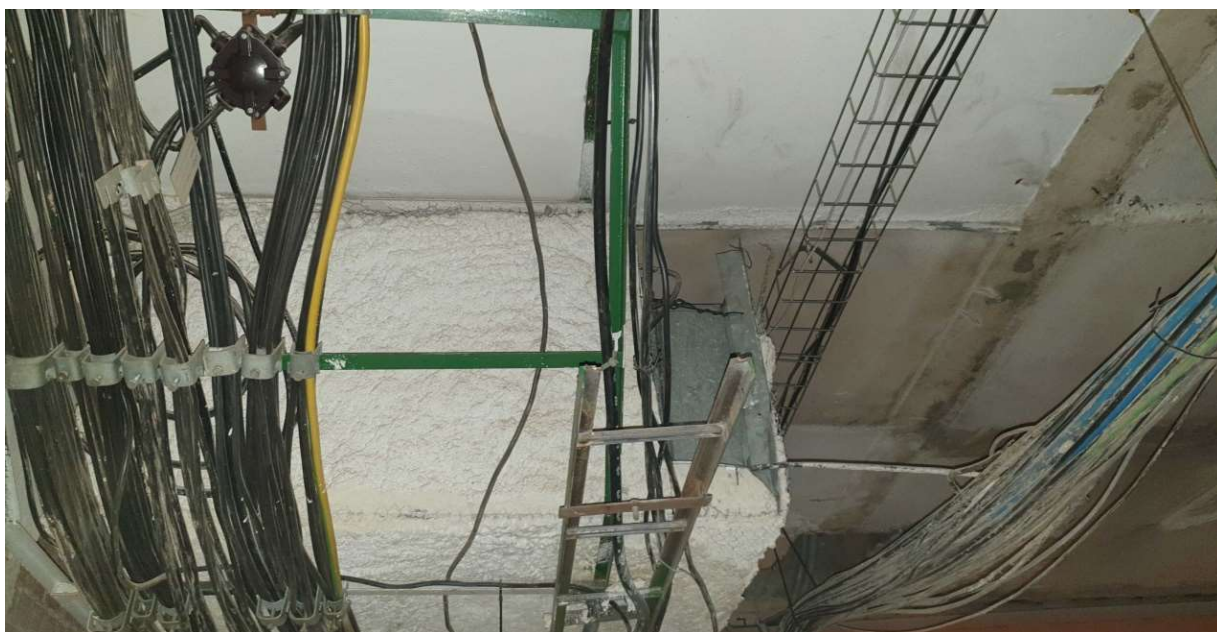
Obr. 9 Aktuální stav horizontální kabeláže a izolace VZT potrubí pod stropem suterénu
