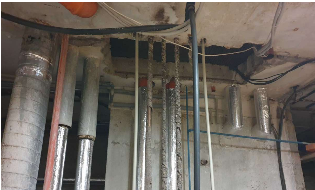
Obr. 6 Stoupačky – aktuální stav vertikálních rozvodů ve stoupačkách
