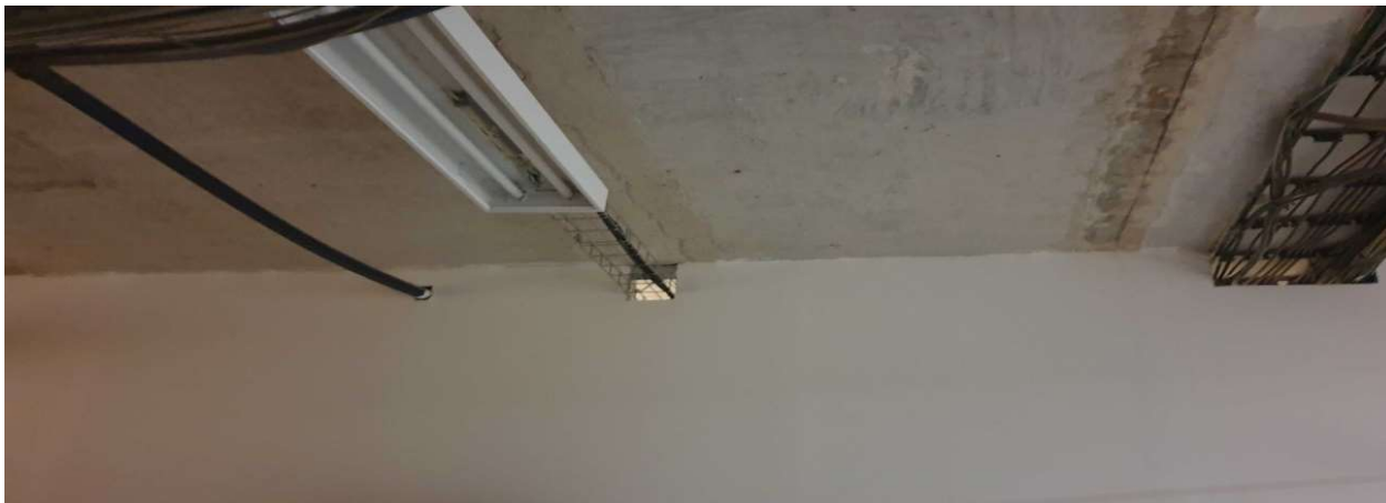
Obr. 10 Aktuální stav prostupů kabeláže skrz stěnu
