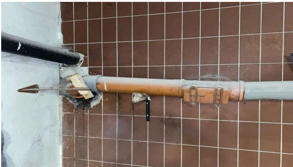
Obr. 17 Aktuální stav – horizontální rozvody kanalizace (havarijní stav) – detail uchycení
