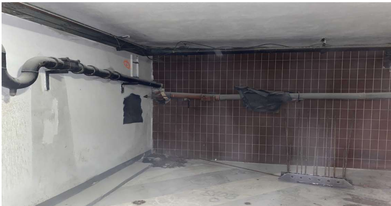
Obr. 16 Aktuální stav – horizontální rozvody kanalizace (havarijní stav) - materiály
