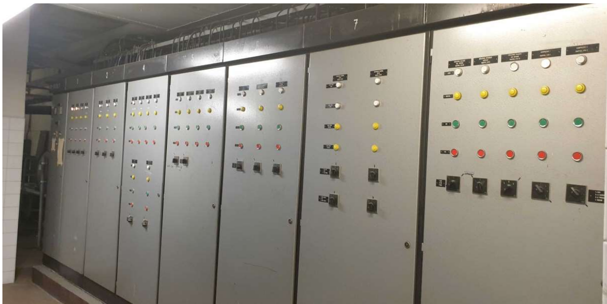
Obr. 12 Aktuální stav - původní rozvaděče měření a regulace z 80. let 20. století
