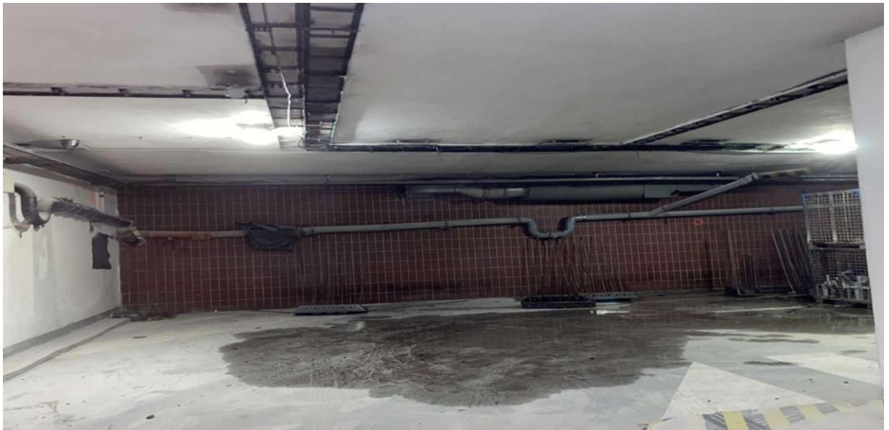
Obr. 15 Aktuální stav – horizontální rozvody kanalizace (havarijní stav)
