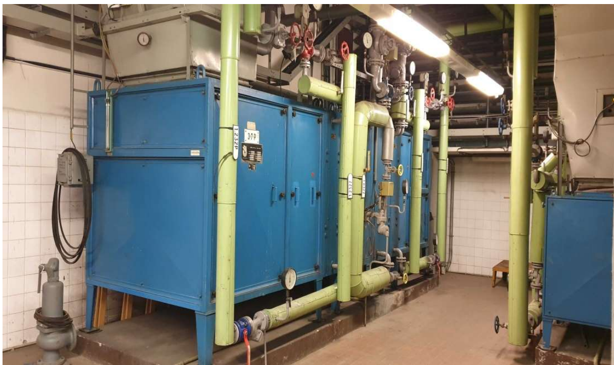
Obr. 4 Strojovna VZT – téměř 40 let staré VZT jednotky (rok 1982)
