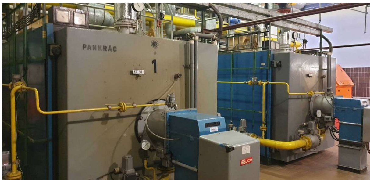
Obr. 18 Kotelna pro celý areál Národního divadla – Původní kotle ČKD DUKLA, typ OMNIMAT 11 – PVG 300 z roku 1981
