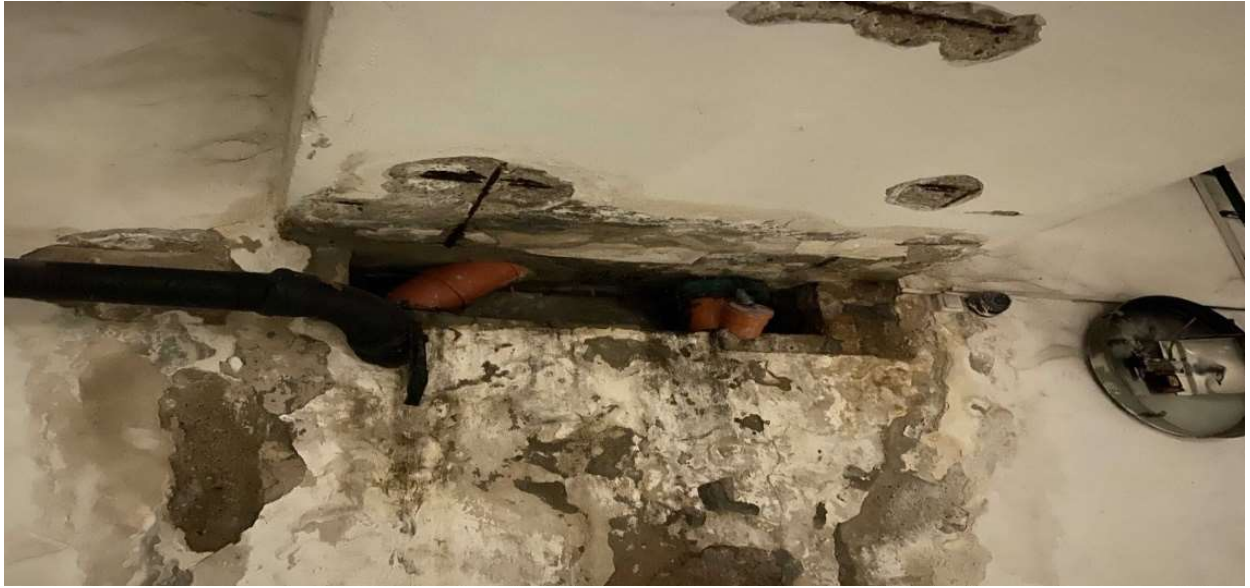
Obr. 14 Aktuální stav – stoupačky kanalizace (havarijní stav)
