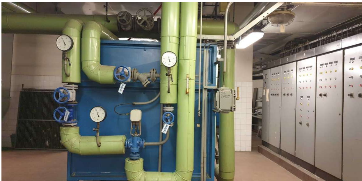
Obr. 5 Strojovna VZT – napojení VZT jednotek, armatury a rozvaděče z 80. let 20. Století
