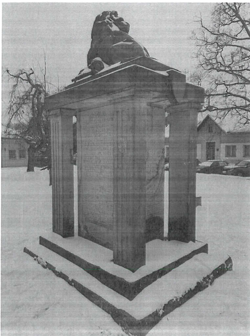
Obr. 3 / Pohled od severu – tato strana je nejvíce namáhána vlhkostí a je proto silně porostlá biologickými porosty, provázejícími výrazné znečištění. Porušenými spárami zatéká na nápisovou plochu. Opatření: vyhubit biologické porosty a vyčistit povrch, odsolit, doplnit defekty, doplnit spáry, konzervovat povrch.
