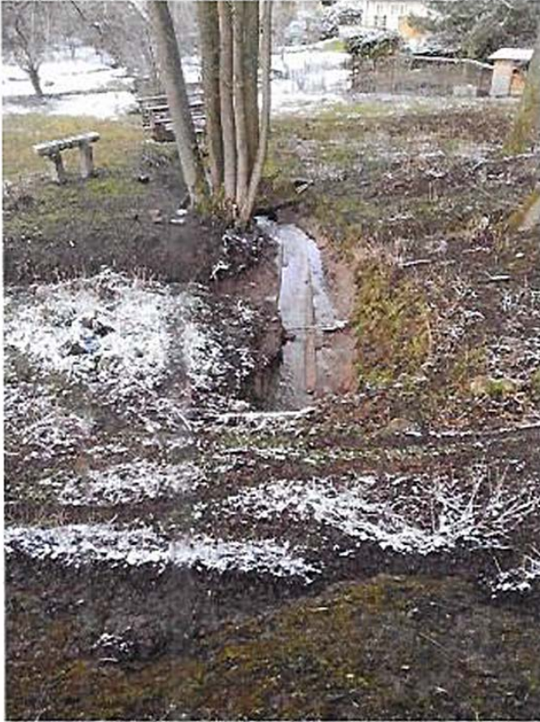
11) Pohled na obnaženou silnoproudou síť v odpadním korytě
