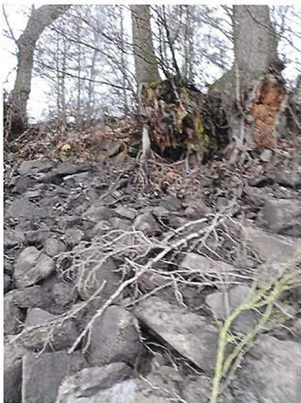
15) Pohled na poškozený stromový doprovod na návodním lici
