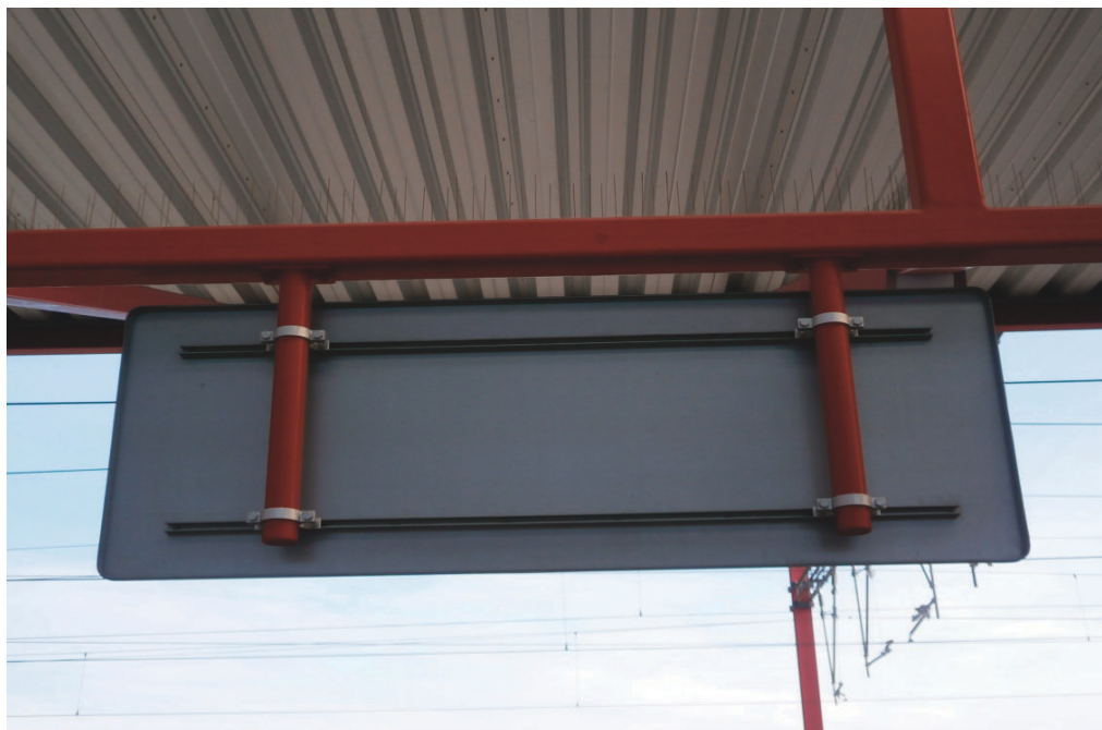
Příklad uchycení tabule ke konstrukci zastřešení (konzoly jsou připravené od výrobce zastřešení, tabule je na ně uchycena na objímky)
