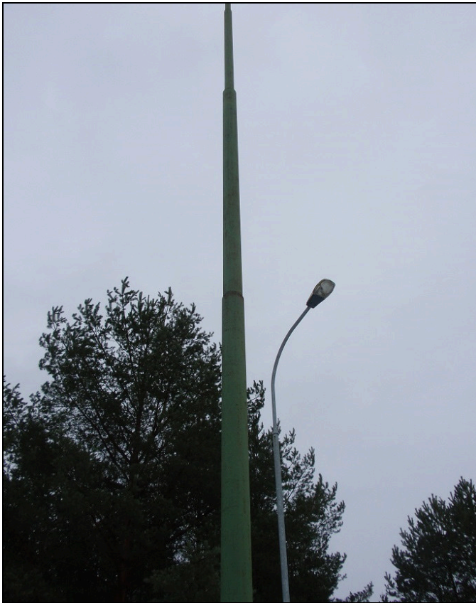
Foto č. 1 - Pohled na oddálený hromosvod
