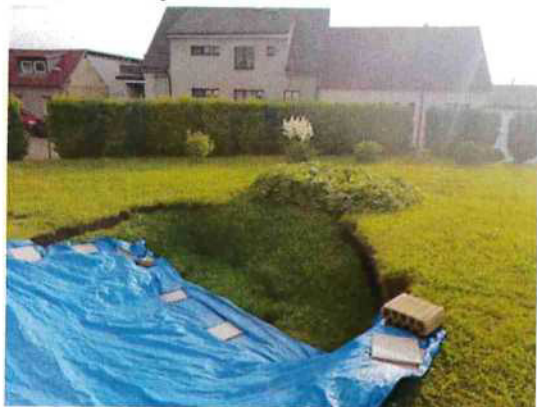
propad zeminy na zahradě u RD
