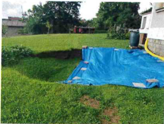
propad zeminy na zahradě u RD
