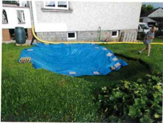
propad zeminy na zahradě u RD
