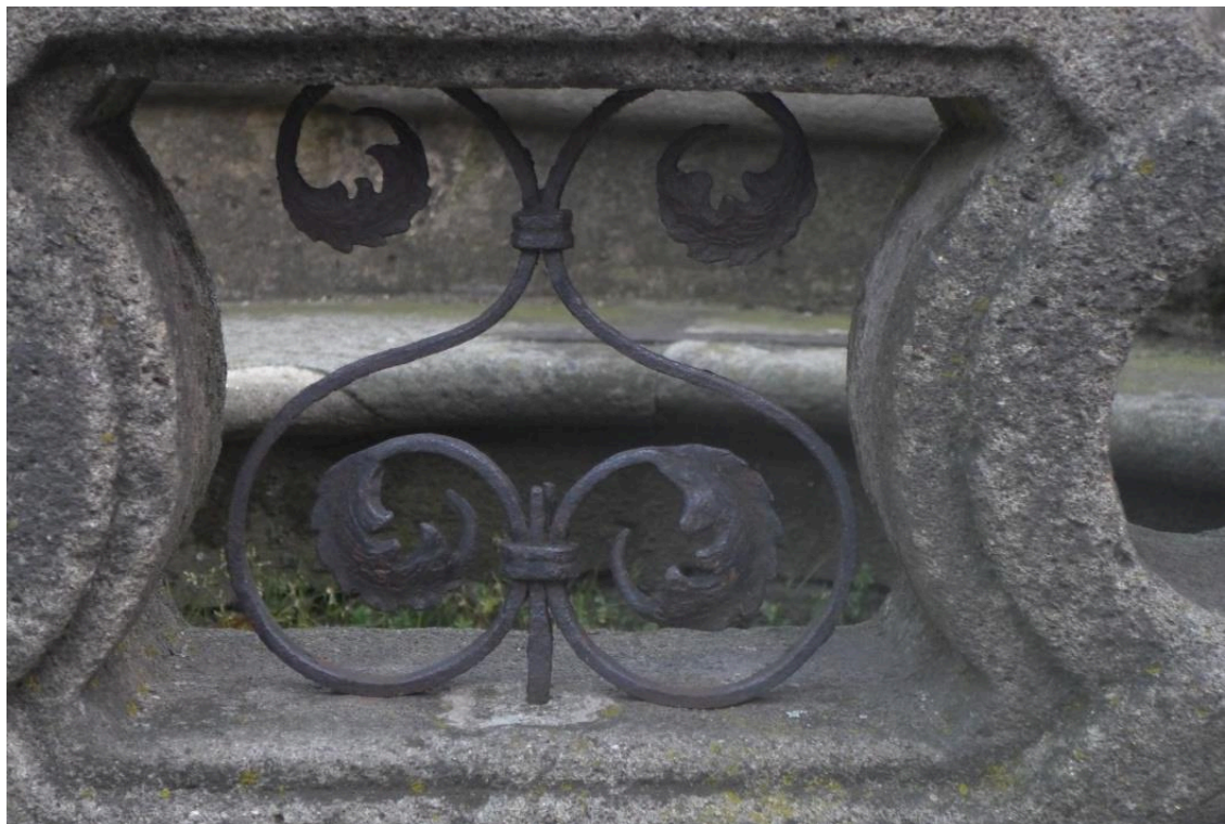
Současný stav Stav kovových částí balustrády, povrch zkorodován, místy plasticky poškozen
