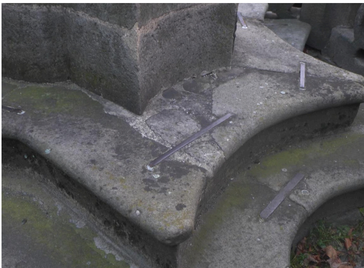
Současný stav Znečištění a poškození spodních prvků, schody značně poškozeny a druhotně opravovány, v
