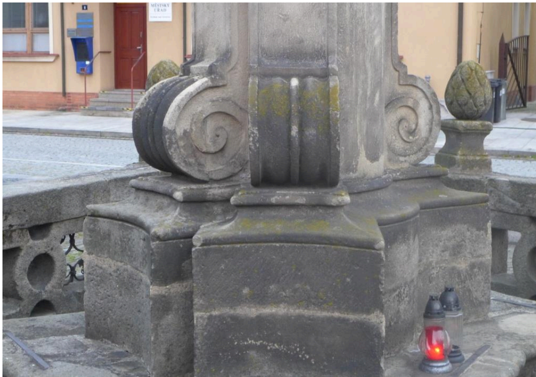
Současný stav Silné znečištění vrcholové sochy i spodních prvků architektury
