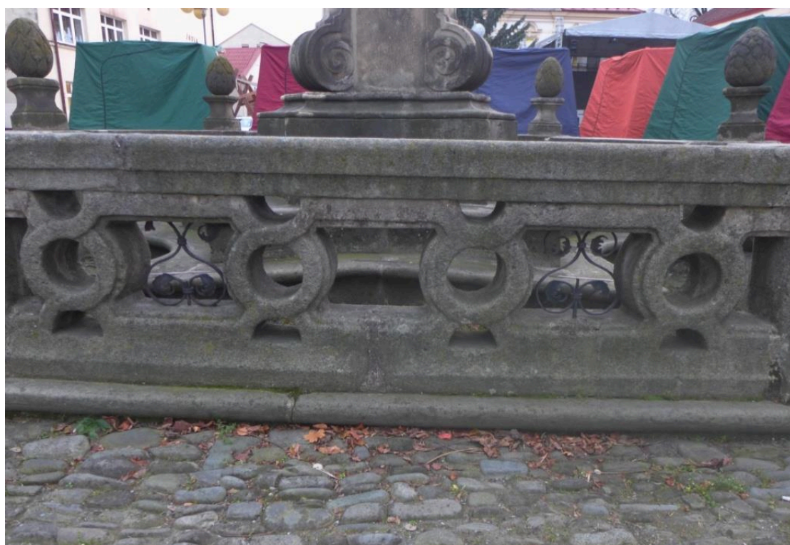
Současný stav Znečištění a poškození spodních prvků, schody značně poškozeny a druhotně opravovány, ve vnitřním prostoru balustrády chybějící jeden kovový prvek
