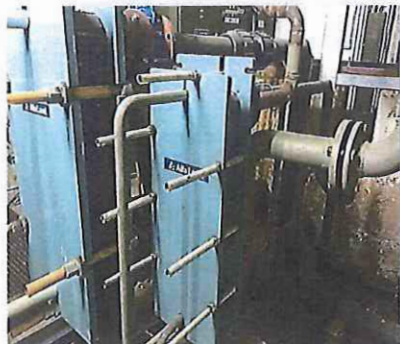
Foto výměníku - zařízení č. 1:
