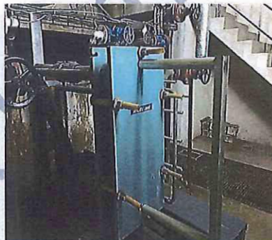
Foto výměníku - zařízení č. 2:
