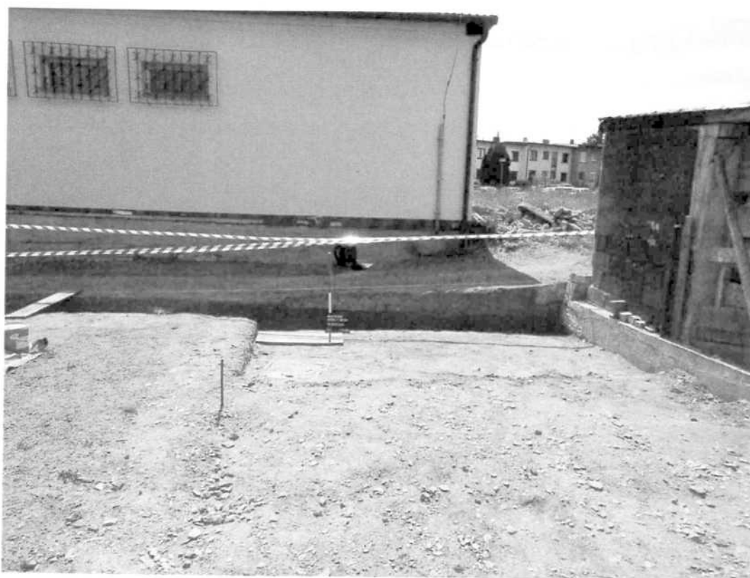
Obr. 01 Celkový pohled na místo propadu od východu, trasírka v propadu ve výkopu, za ní je viditelný sousední objekt prodejny.
