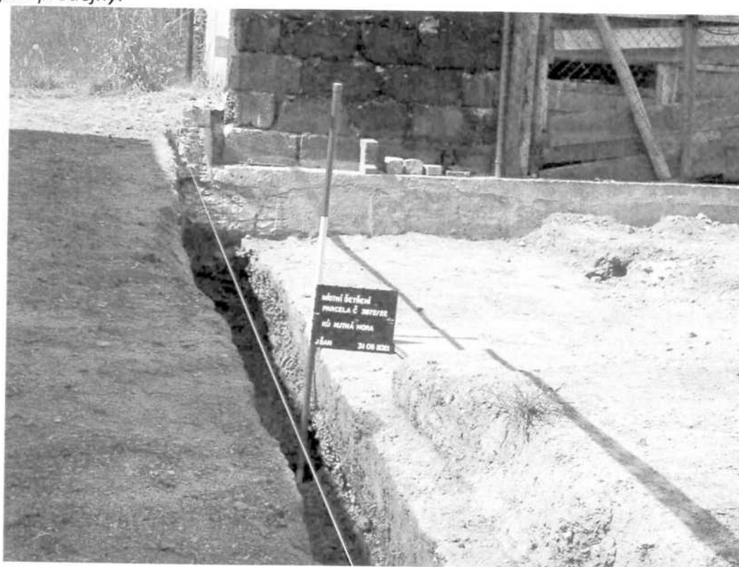
Obr. 02 Bližší pohled na výkop, trasírka v místě propadu.
