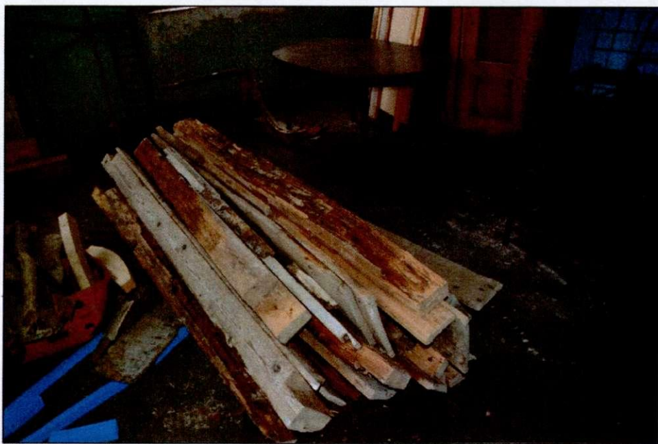
Detail původní podlahy lavicových bloků poškozené vlhkostí, houbami a dřevokazným hmyzem
