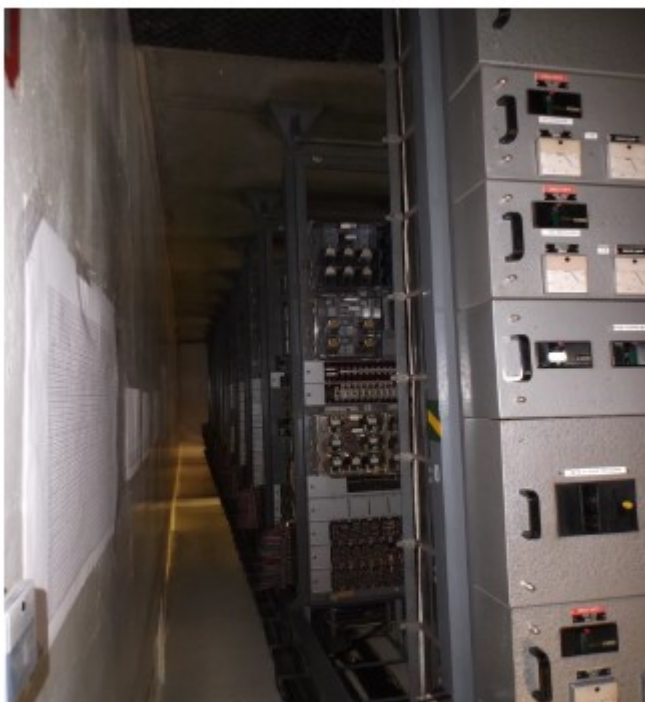
Obr. č.5 – Zabezpečovací technologie
