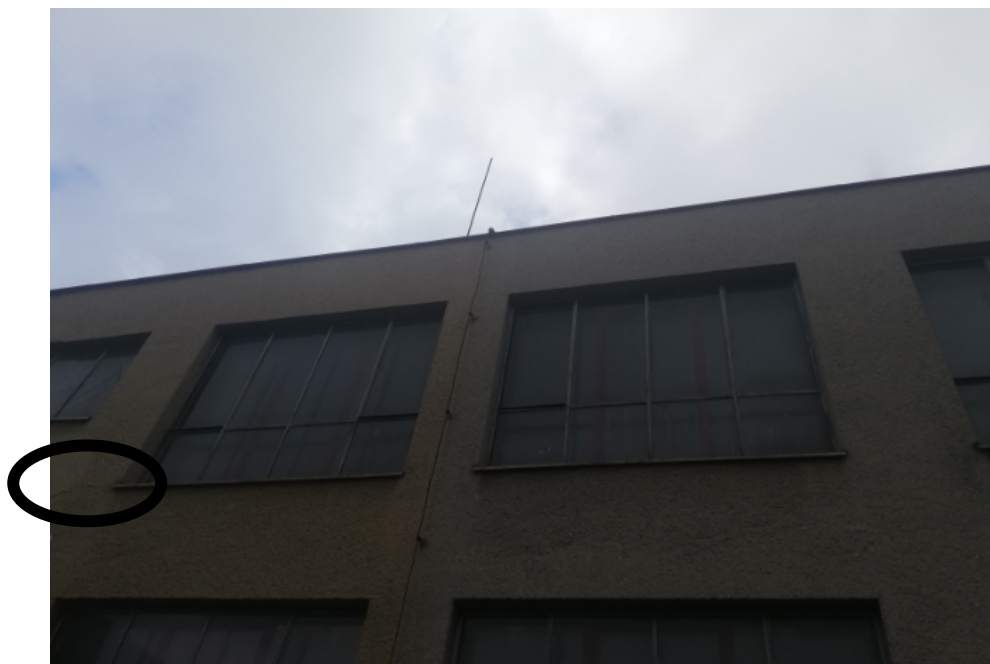
5) Pole vlevo dle obr č. 1 – trhliny černě
