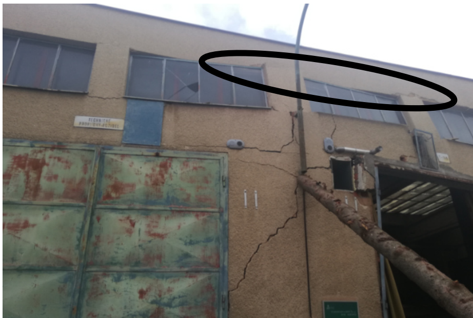
8) Ukázka poškození podepření atiky objektu.
