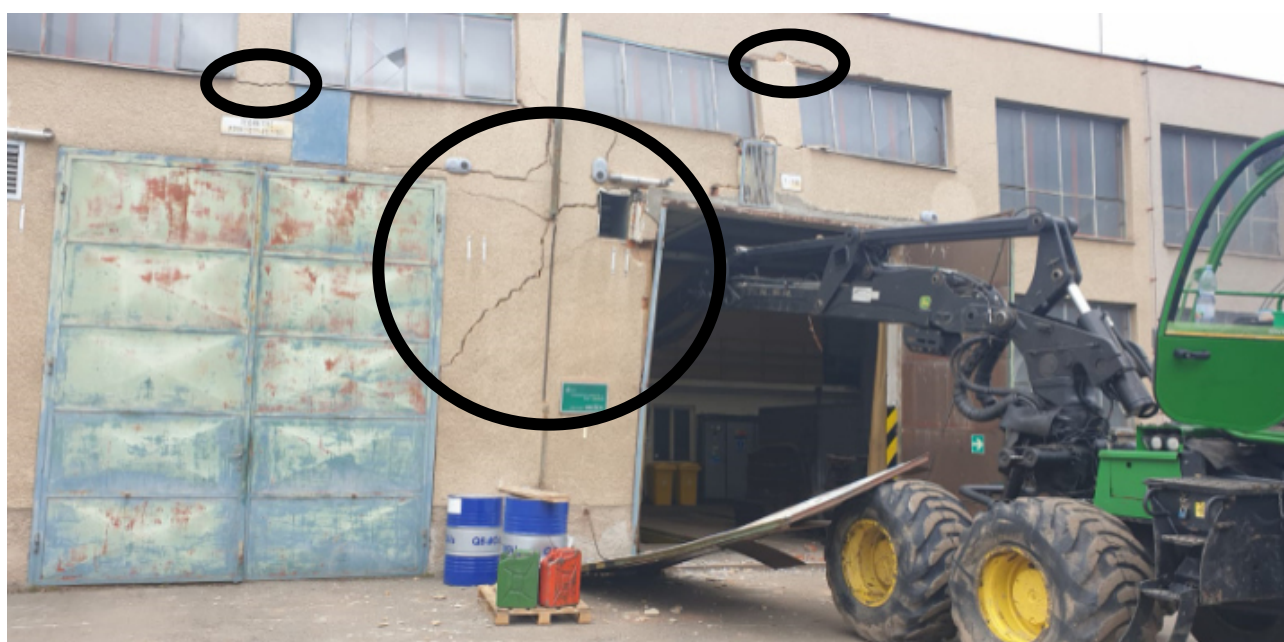
4) Čelní pohled – trhliny černě
