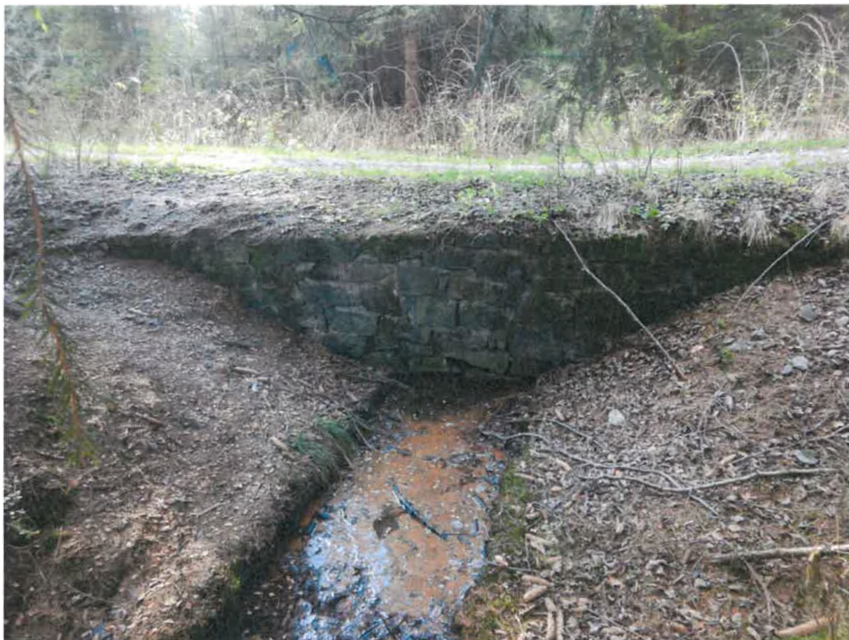
Obr. : Těleso propustku na příkopu č. 7 se pomalu boří do rašeliny (z 49.6374908N, 15.8831522E k Z).
