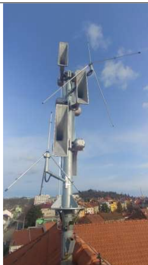
Obr. ES.23-2 – detail stožáru, 6 ozvučnic na novém stožáru, antény VIS a JSVV na výložníku
