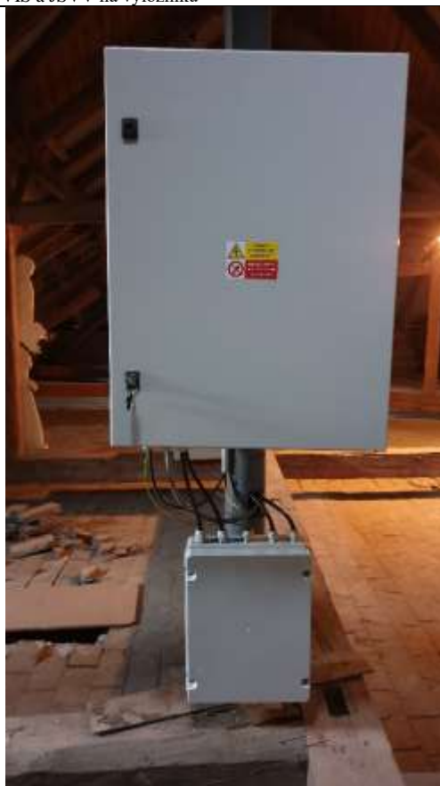
Obr. ES.23-4 – umístění rozvaděče sirény a krabice přepětových ochran na stožár v půdním prostoru
