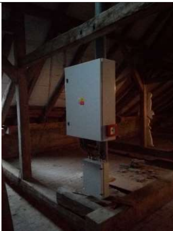
Obr. ES.23-5 – umístění rozvaděče sirény a krabice přepětových ochran v kanceláři, tlačítko místního ovládání
