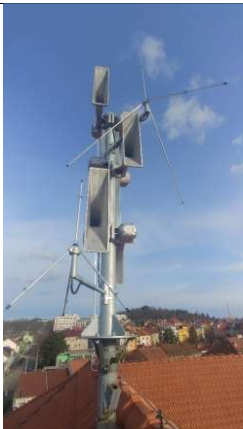
Obr. ES.23-3 – umístění konstrukce s novým stožárem sirény na střeše mateřské školy, oddálený jímáč hromosvodu
