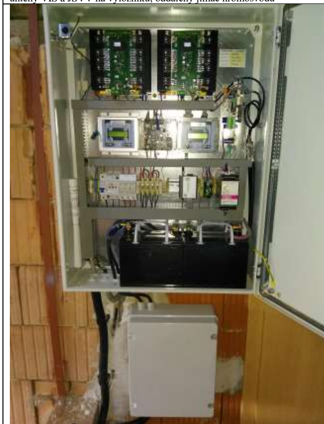
Obr. ESN.15-3 – otevřený rozvaděč sirény
