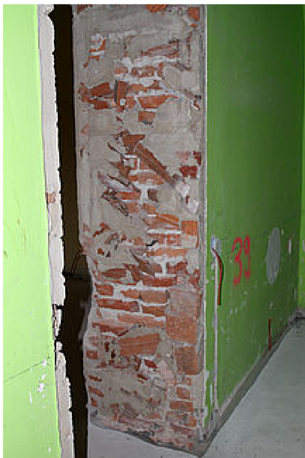
Změna 119 – Úprava stěny v m. č. 123 (dozdění Ytong 50 mm) – křivost stěn
