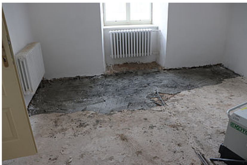
Změna 105 – Podlahy m. č. 118, 120, 130 – popraskané, nerovné podlahy s klenbami pod
