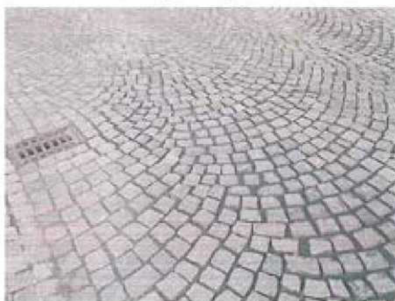
Plošná deformace, nefunkční odvodnění
