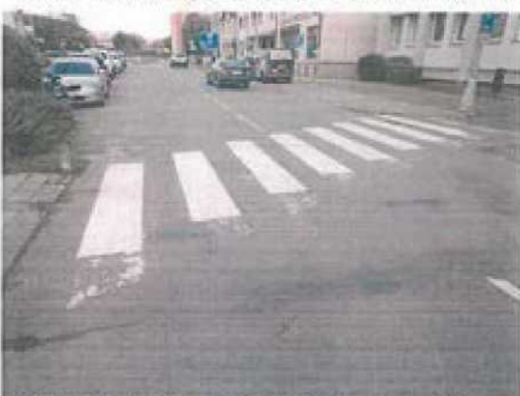
Příčná široká trhlina, mozaikové trhliny, vysprávký
