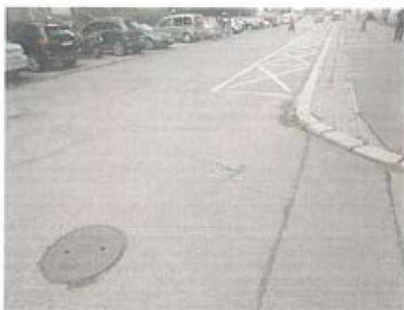
Hl. koroze, příčná trhlina, vysprávký, umístění sondy S 1
