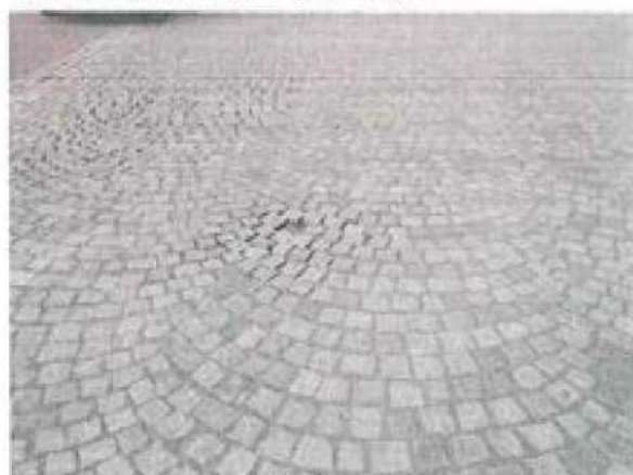
Plošná deformace, chybějící prvek dlažby
