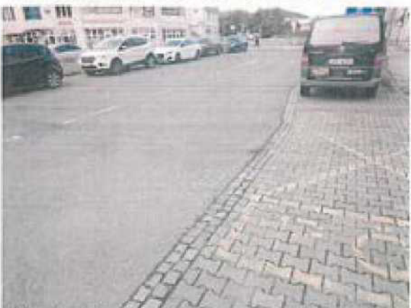
Hlubková koroze, příčná trhlina, umístění sondy S 2
