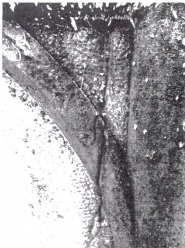
B/ Detail otevřené trhliny na povrchu pískovce
