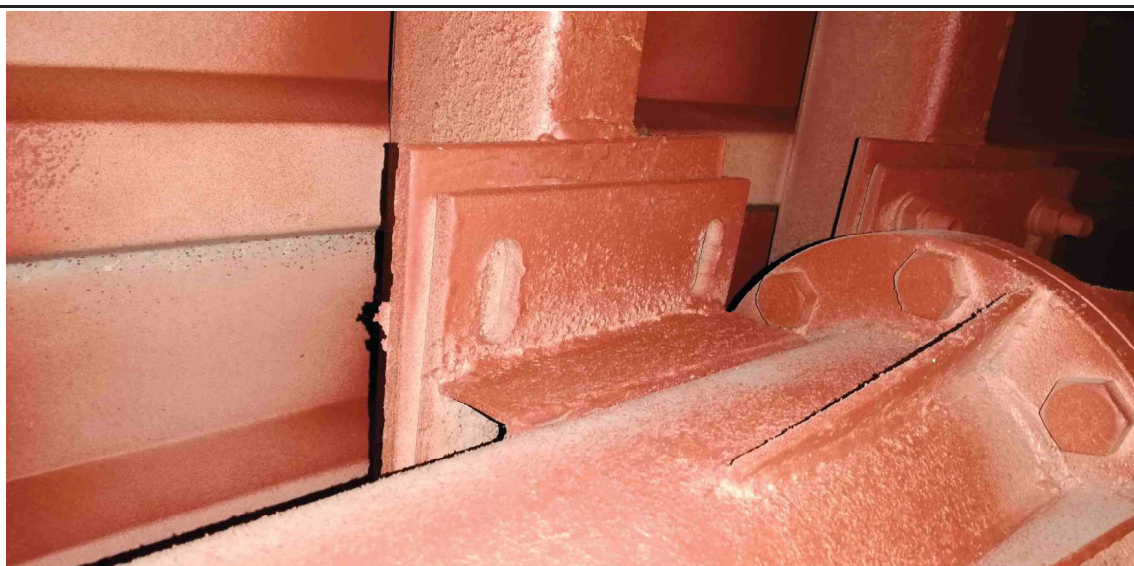
9.3 – Pohled na vazníčky, chybějící šrouby
