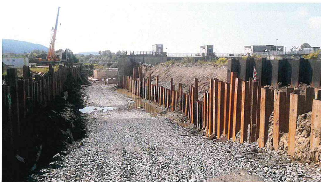
Obrázek 4: Viditelné průsaky přes štětovnicovou stěnu v nadjezí
