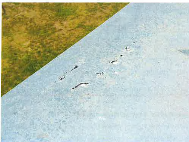
foto /3/ Koroze TiZn parapetů
