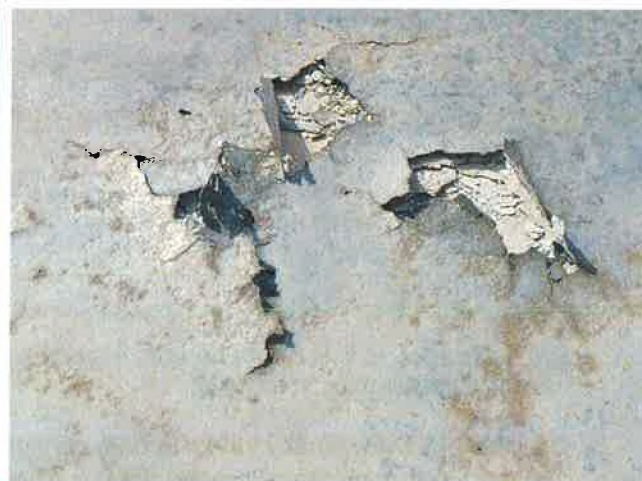
foto /2/ Koroze TiZn parapetů
