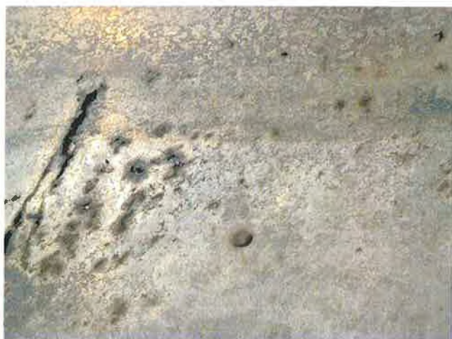
foto /4/ Koroze TiZn parapetů
