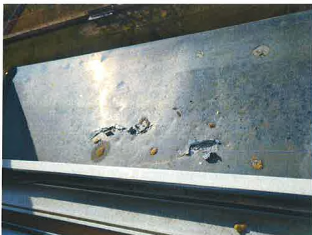
foto /1/ Koroze TiZn parapetů
