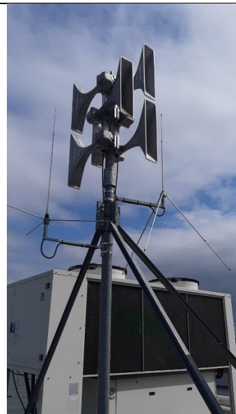
Obr. ESH.5-2 – detail stožáru, 8 ozvučnic na novém stožáru, antény VIS a JSVV na výložníku
