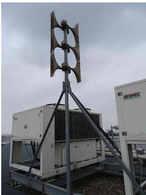
ESH.5 – stávající elektronická siréna
