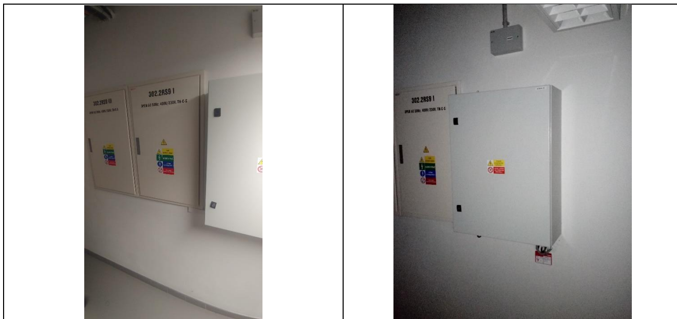
Obr. ESH.5-3 – umístění rozvaděče sirény na chodbě
