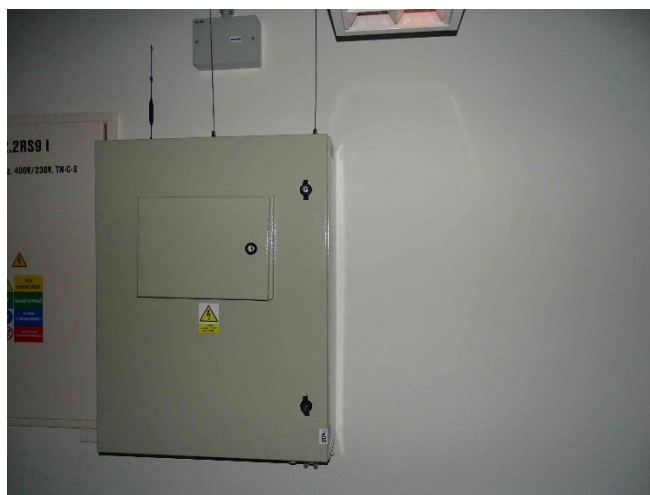
ESH.5 – umístění rozvaděče stávající sirény, na chodbě
