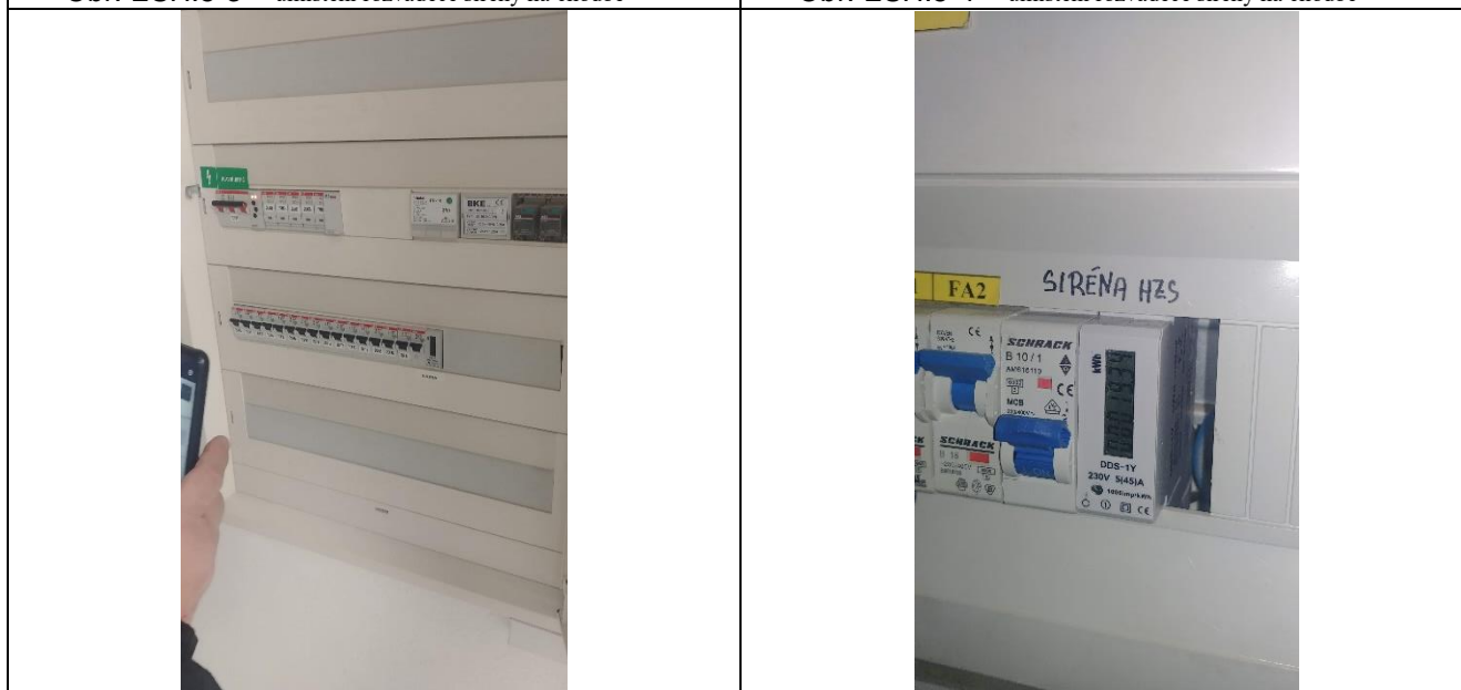
Obr. ESH.5-5 – rozvaděč napájení s jističem 10A/B a podružným elektroměrem přívodu
