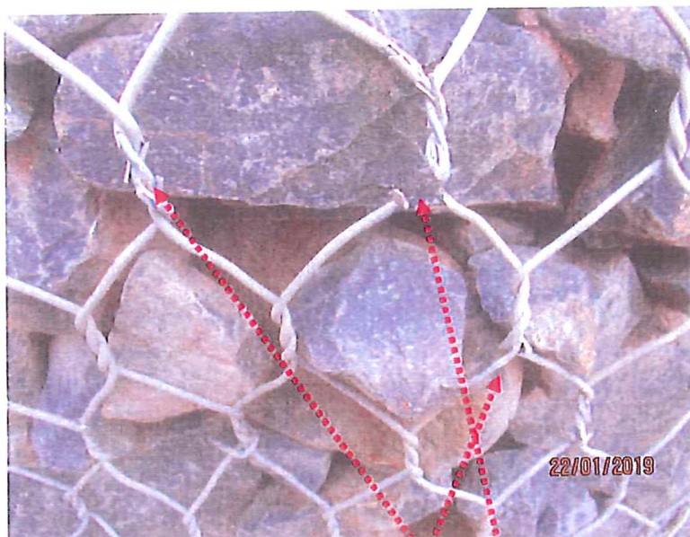
F6 stržení ochranné vrstvy PVC pletiva košů prasklé pletivo
