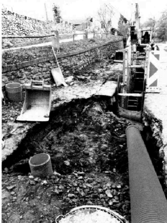
Obr. 3 – poruchy na povrchu komunikace
