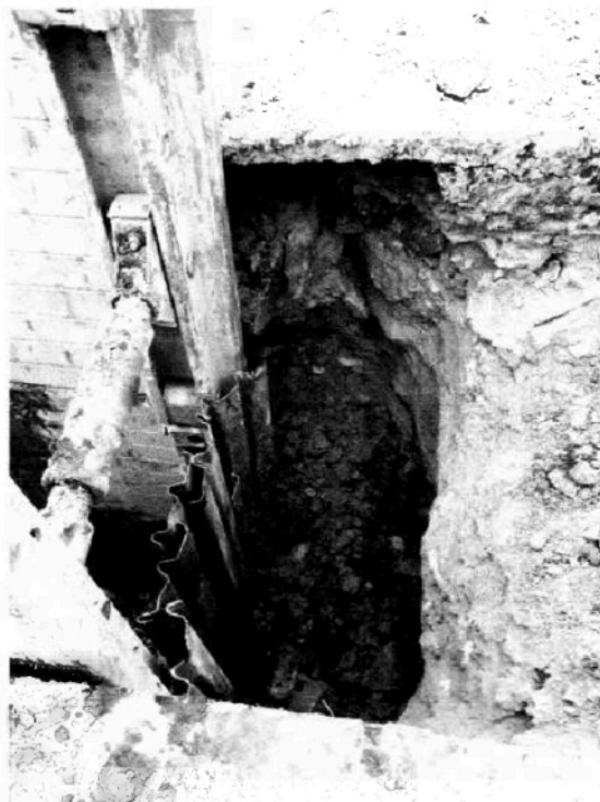
Obr. 2 – kaverny v podloží vozovky
