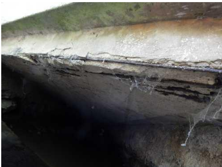
Obnažená korodující výztuž vpravo na nosné konstrukci
