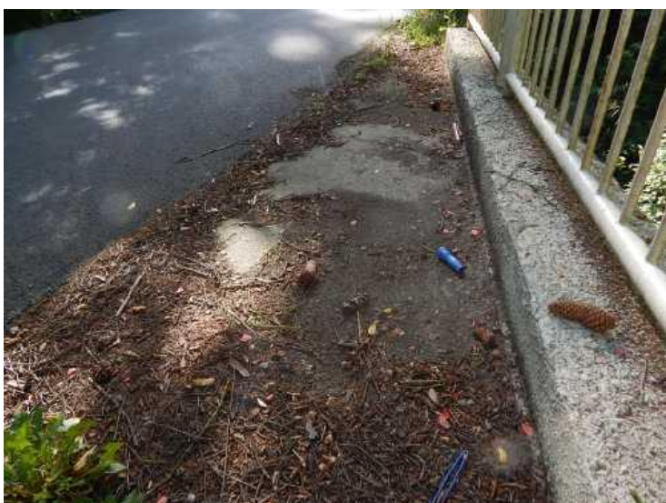
Nečistoty na mostním svršku
