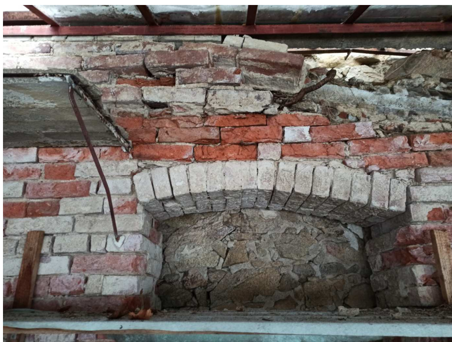
Poškozené zdivo nad klenbou, zatékání do konstrukce a následná degradace
