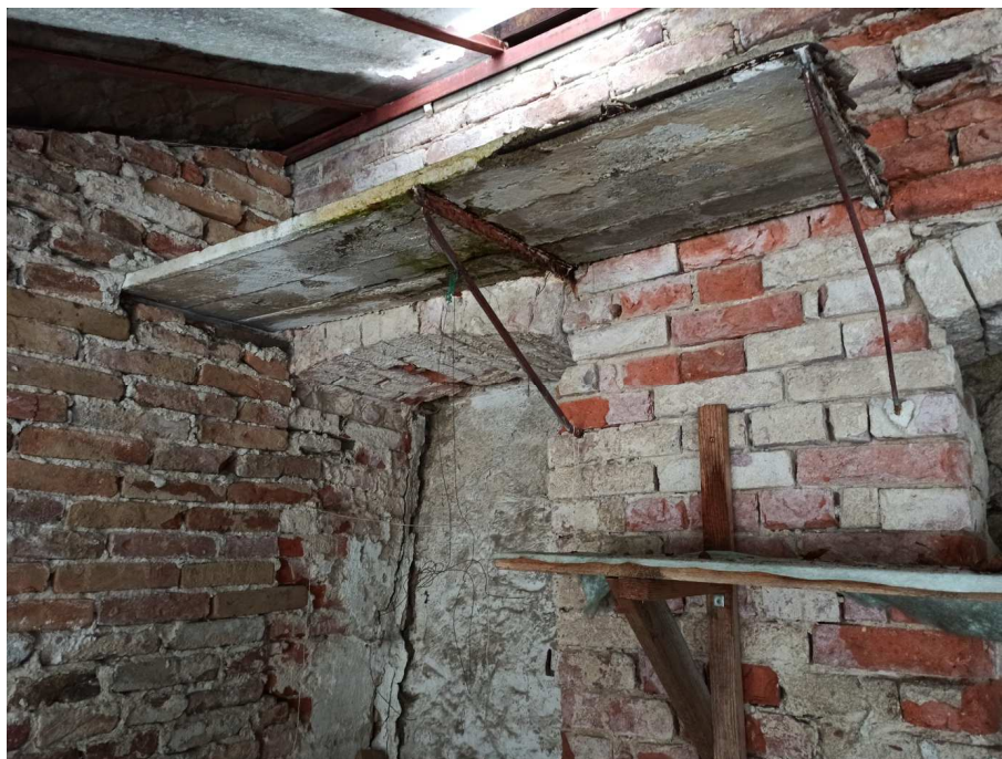
Vnitřní prostor skleníku, degradace a poruch zdiva
