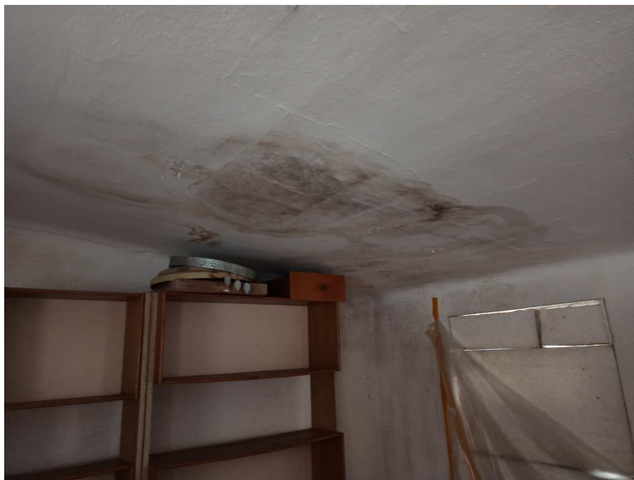
Zatékání do pultové střechy, nutná oprava a sanace prvků krovu
