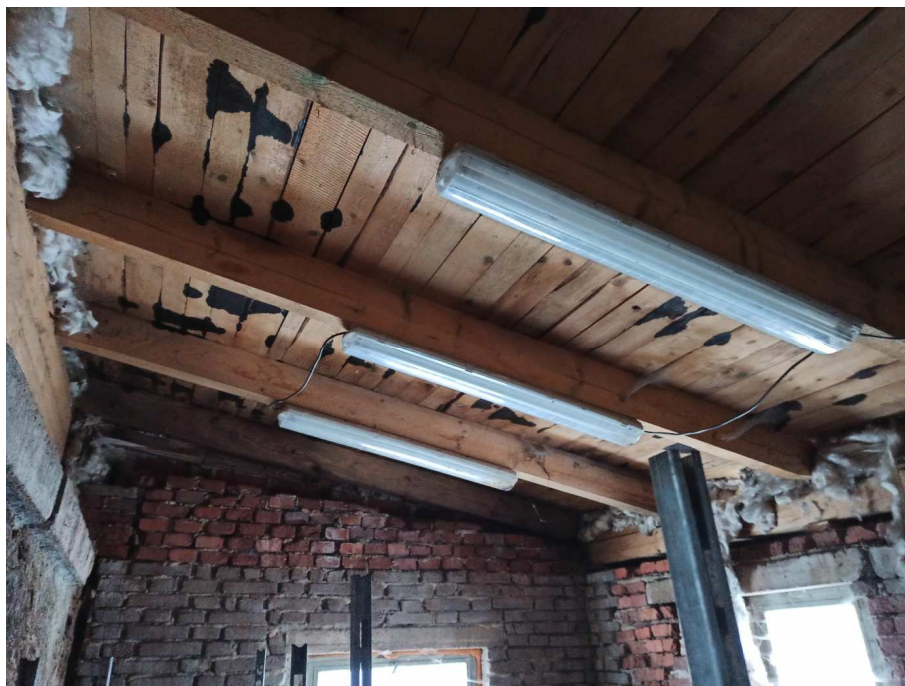
Nová konstrukce pultové střechy přístavby. Kompletace a kotvení střechy nebylo dokončeno.
