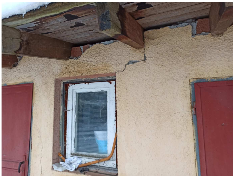
Poškozené dřevěné krokve od srážkové vody, nedokončené klempířské prvky, nevyhovující ztužení přístavby, trhliny ve zdivu
