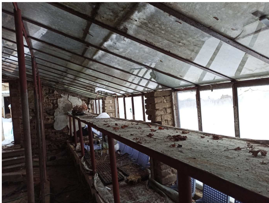
Nevyhovující ocelová konstrukce a zasklení pro přenos zatížení sněhovou vrstvou. Zděné nosné konstrukce jsou degradovány vlhkostí.
