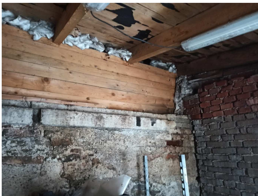
Nežádoucí nastavení štítové stěny na vlhkém zdivu
