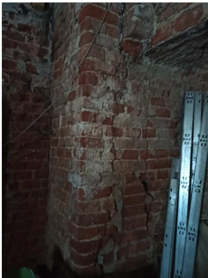
Poruchy komínového zdiva, nutná bezodkladná oprava zdiva a provedení kontroly navazující konstrukce komína!
