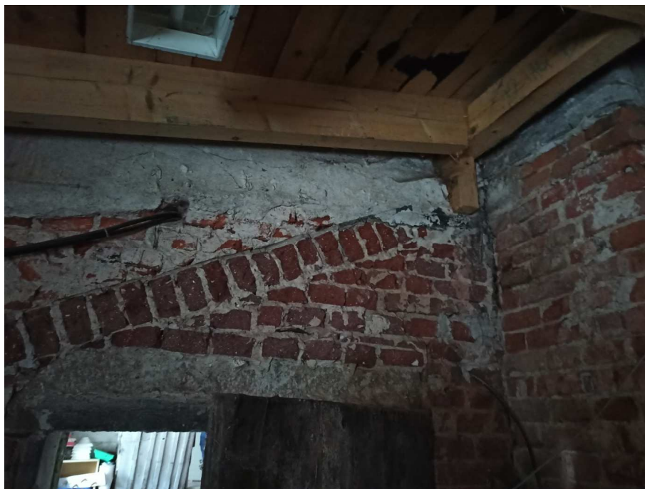
Chybně prováděné zdivo postupnými dozdvímkami bez pravidel zdění, zásah do zdiva od nové konstrukce pultové střechy.
