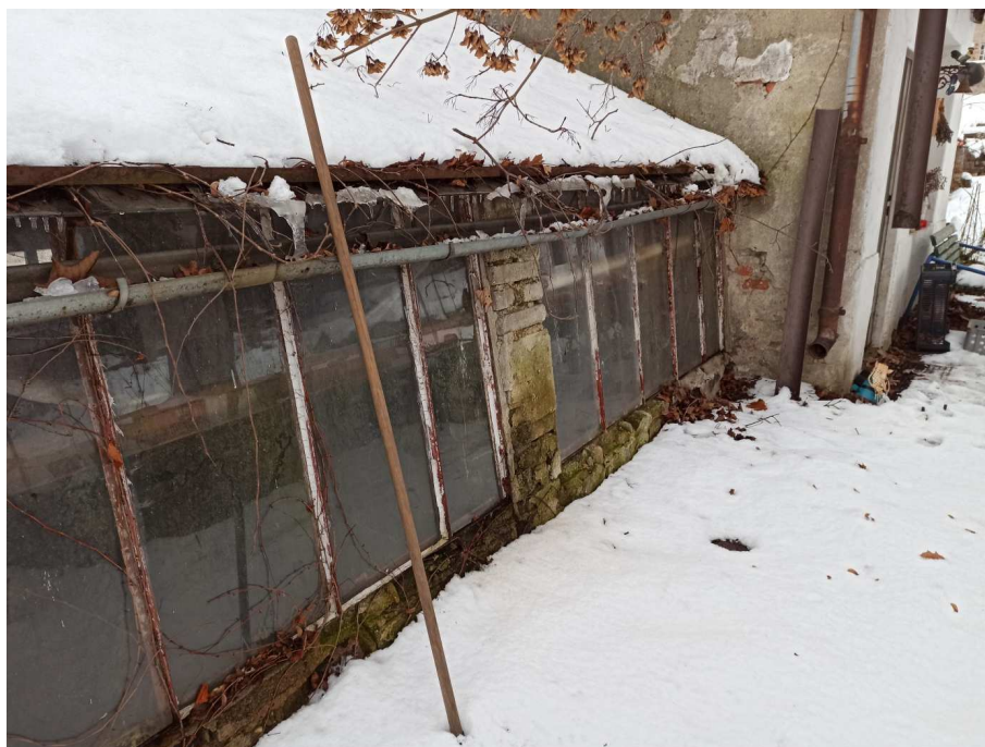
Vestavba skleníku mezi objekty, havarijný stav podezdívky, zatékání v okolí skleníku, Degradace ocelové konstrukce a skel.
