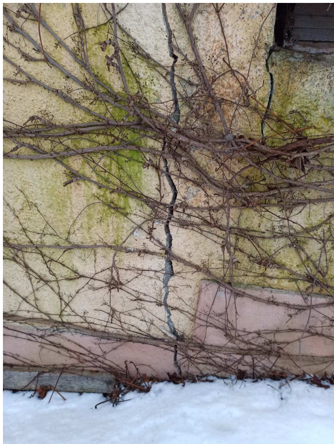
Trhlina ve zdivu u bočního objektu.
