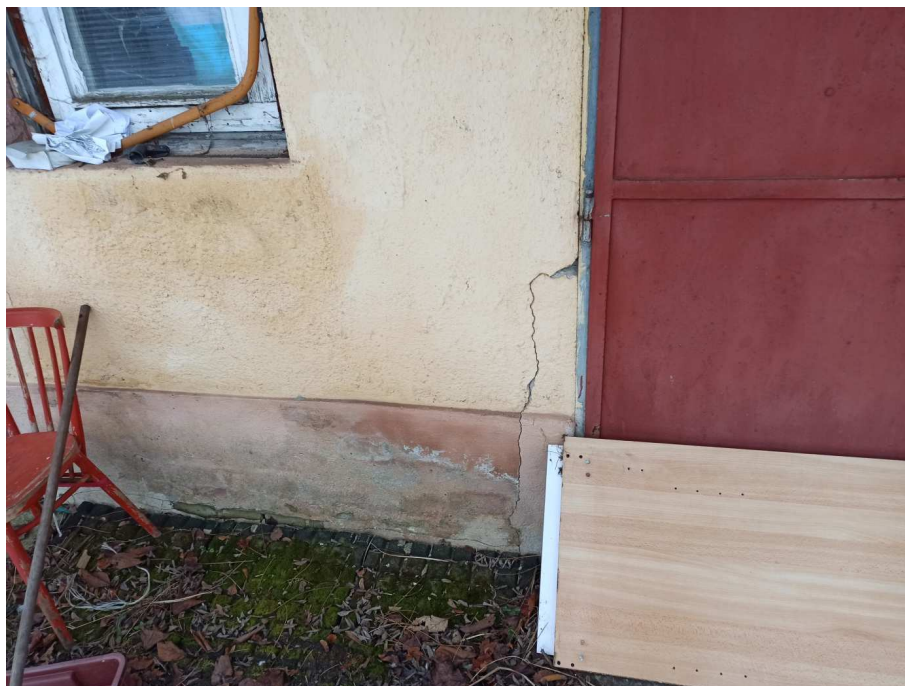
Trhliny ve zdivu, nadměrná vlhkost ve stěnových konstrukcích od srážkových vod a zemní vlhkosti
