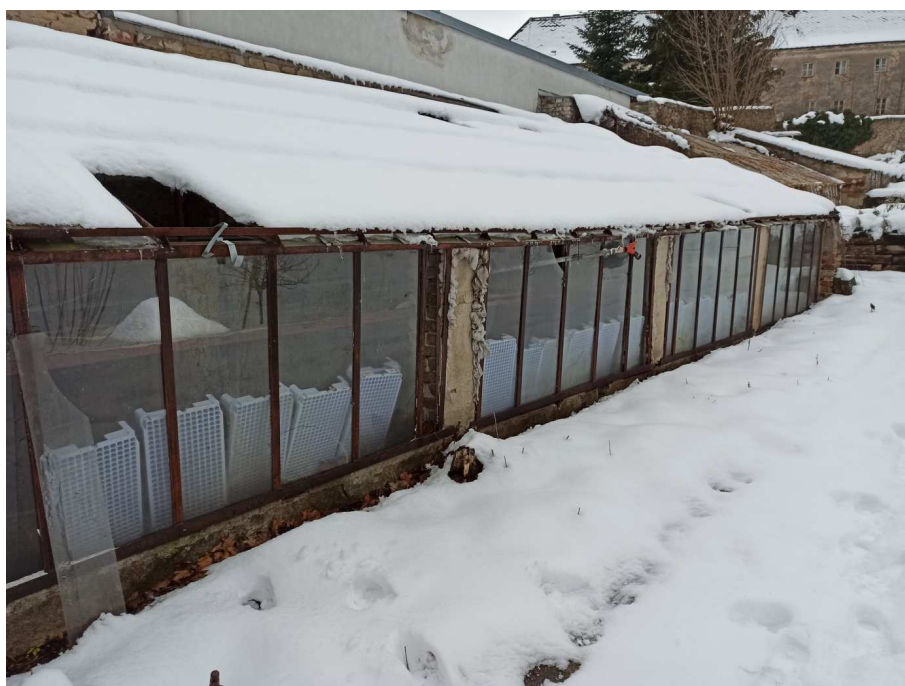
Venkovní skleníky, neudržovaná konstrukce skleníků, podmáčení a degradace materiálů
