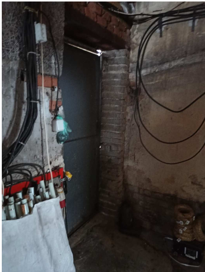
Podzemní část hlavního objektu, různorodé materiály, nevyhovující umístění elektroinstalace, povrchová vlhkost konstrukcí
