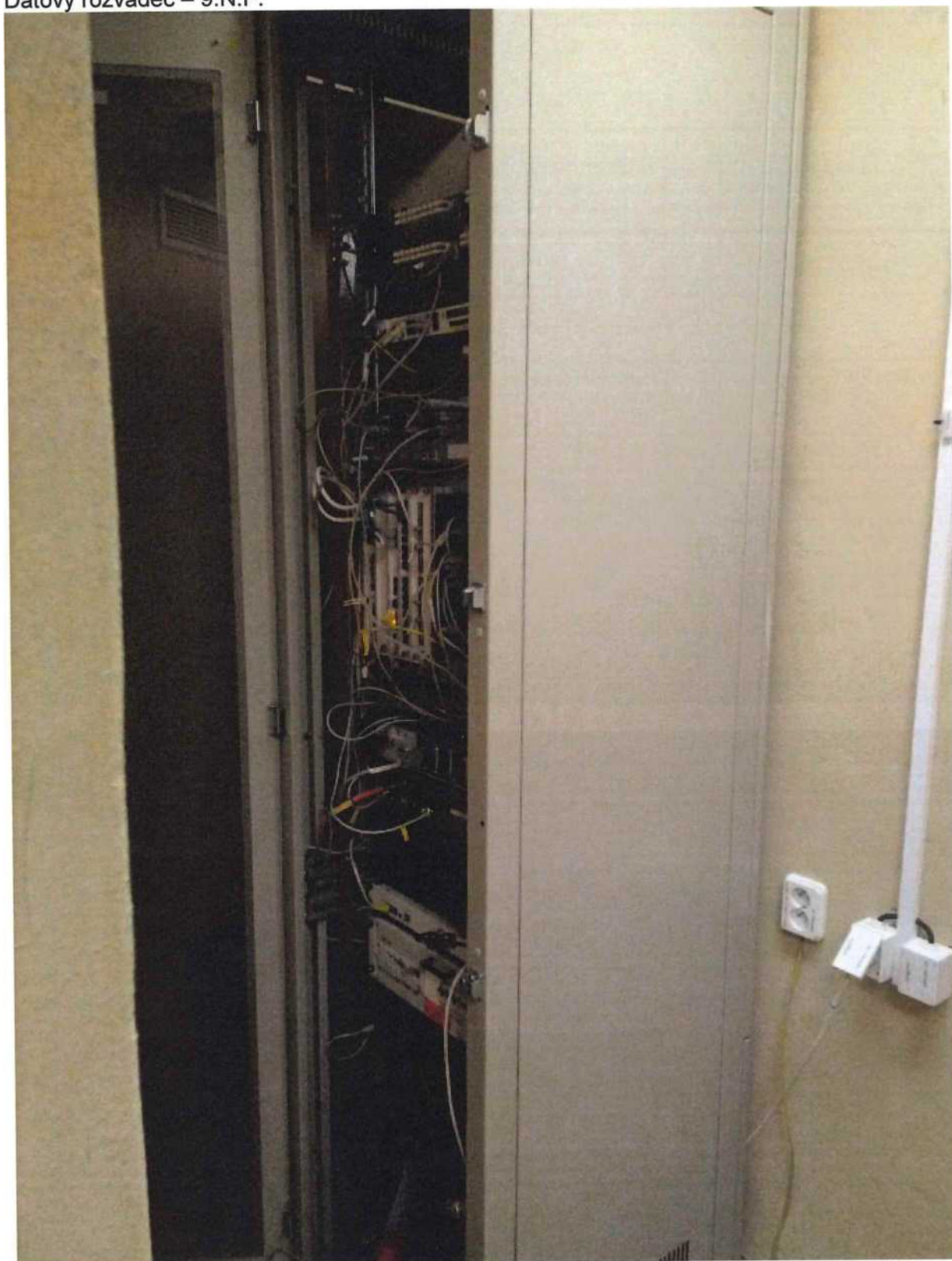
Datový rozvaděč – 9.N.P.
