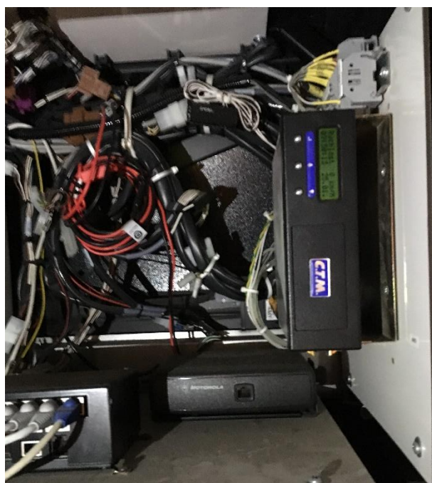
Obr. 2 umístění radiostanice ve vozidlech SOLARIS (v prostoru schránky v kabině řidiče)
