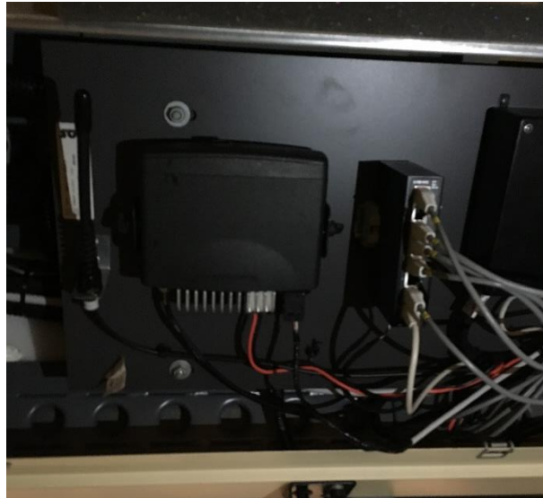
Obr. 3 umístění radiostanice ve vozidlech SOR (v prostoru za prvními dveřmi)
