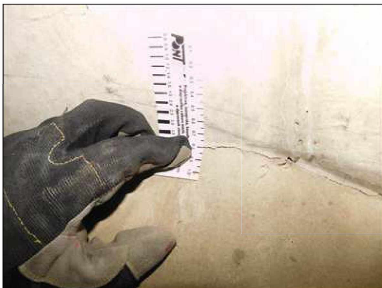
Dtto - detail - šířka trhliny je 0,8 mm.
