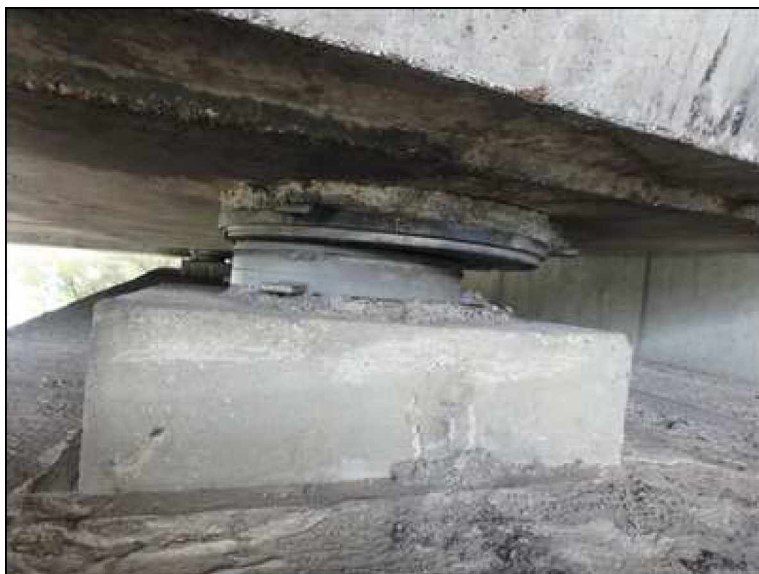
Pravé ložisko na opěře 4 - mimo rozsah.
