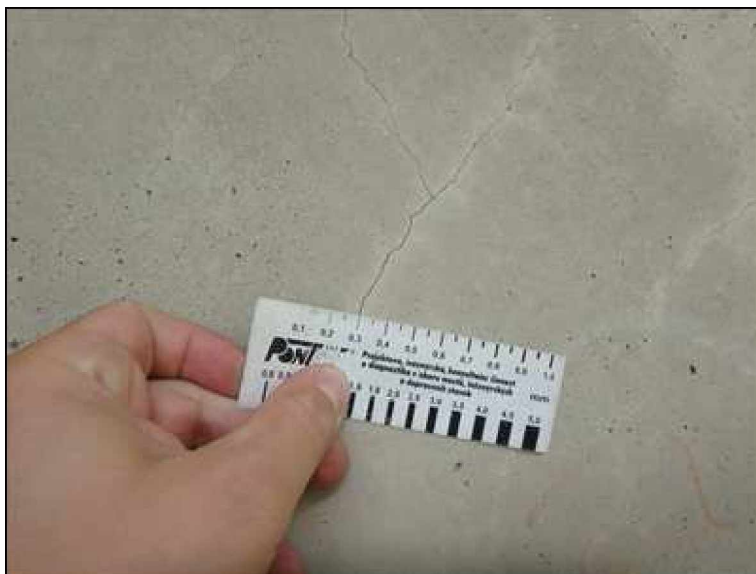
Dtto - detail. Šířka trhliny 0,3 mm.
