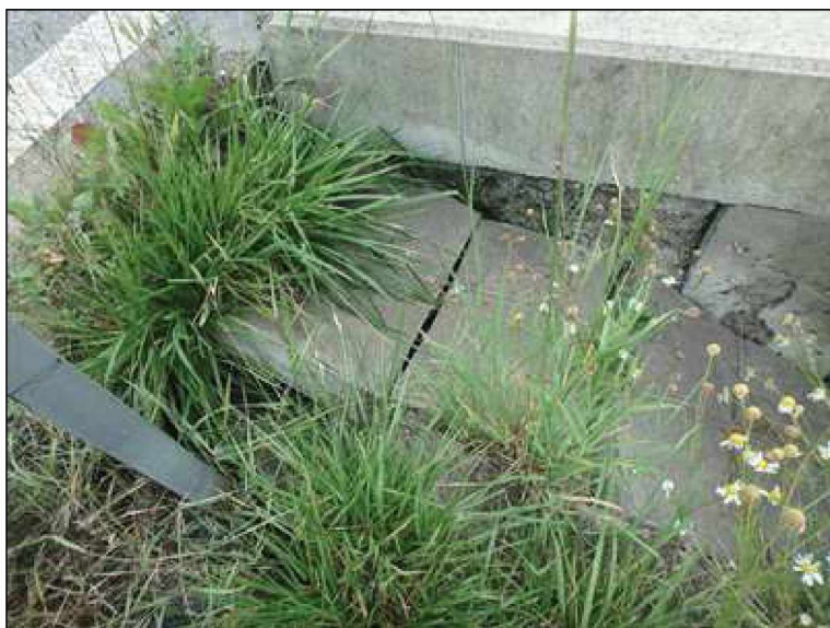
Podemletý odvodňovací skluz u opěry 1.
