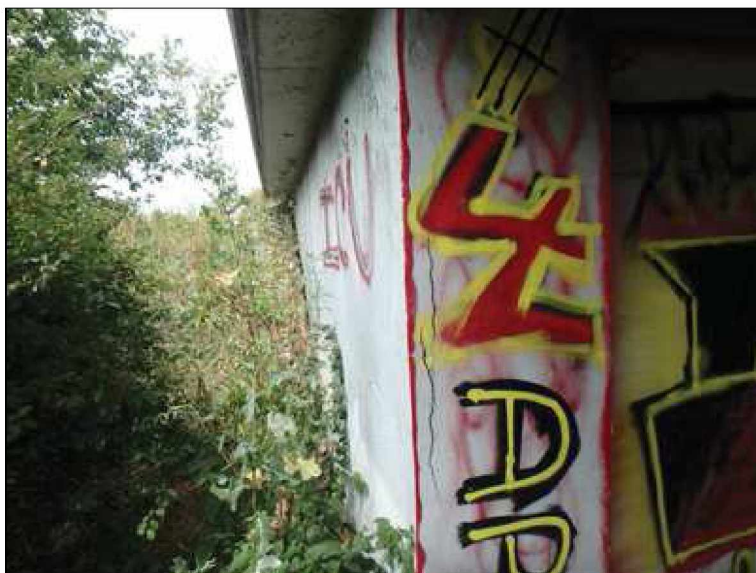
Svislá trhlina v hraně opěry 1 a křídla.
