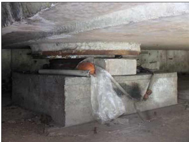
Pravé ložisko opěry 1 - nečistoty v okolí.
