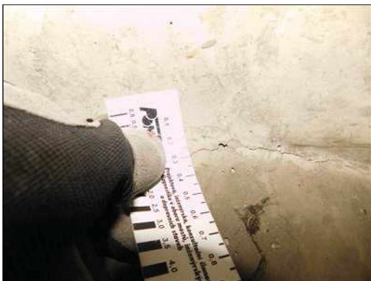
Dtto - detail - šířka trhliny 0,3 mm.
