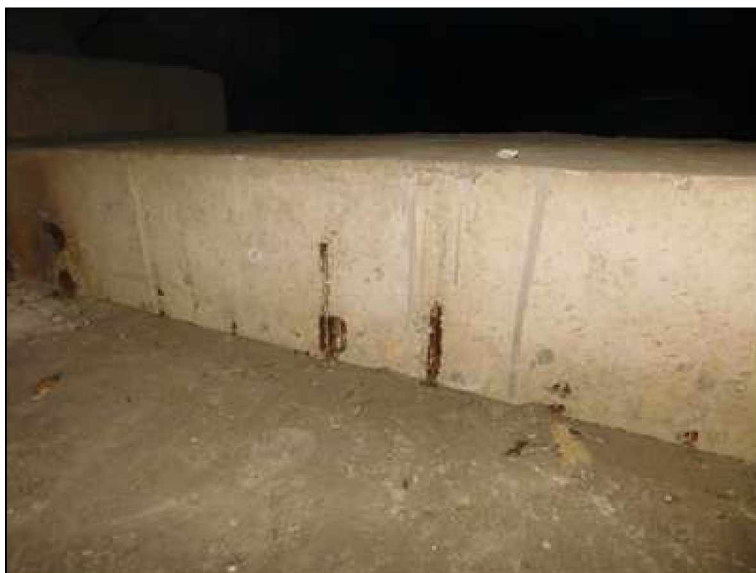
Obnažená korodující výztuž na nadpodporovém příčniku v dutině nosné konstrukce.
