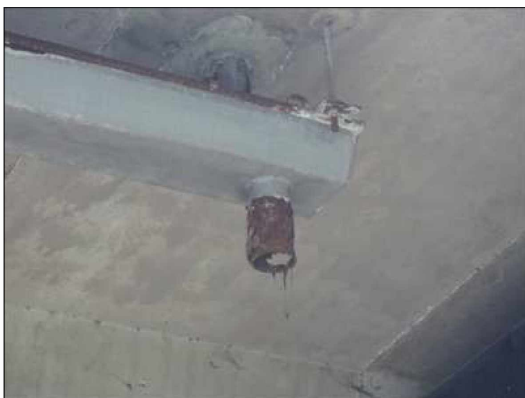
Koroze odvodňovacího žlabu a roury.
