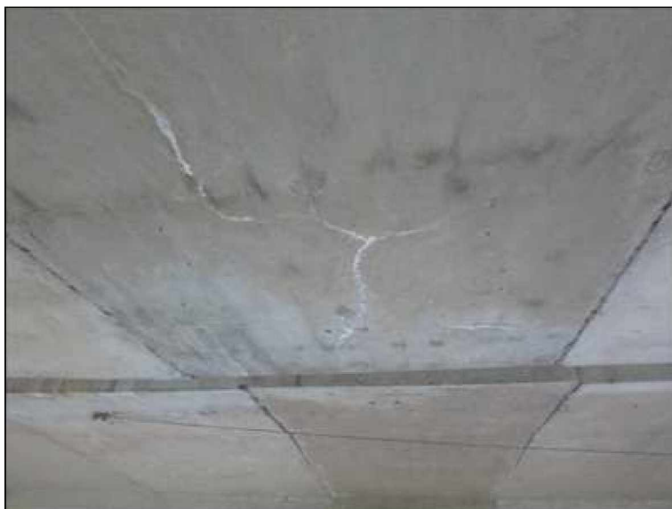
Trhliny s výluhy na podhledu levé konzoly pilíře 2.
