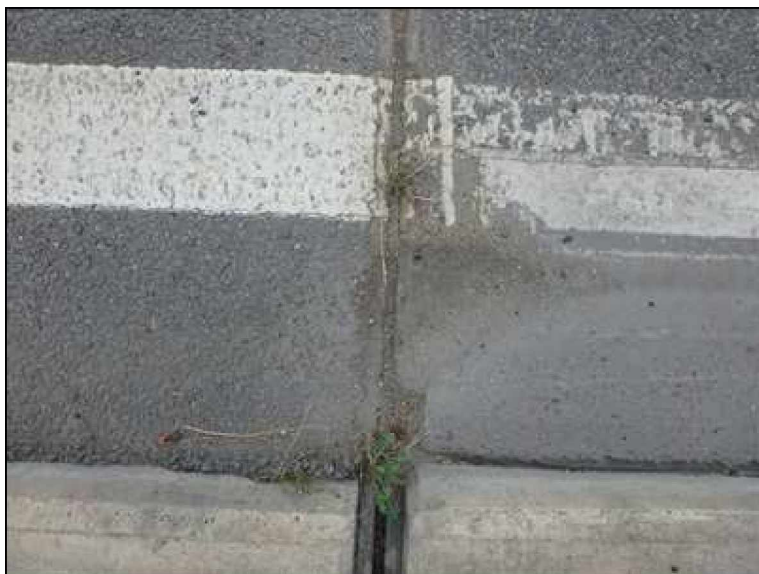
Nečistoty v krajnici vozovky. Uchycená drobná vegetace v mostním závěru.
