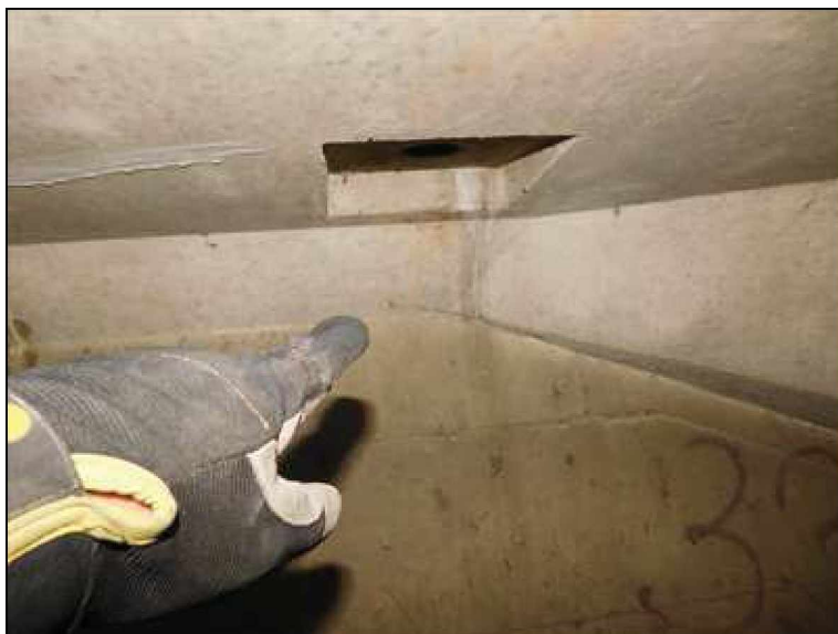
Trhlina mezi boční stěnou a horní deskou nosné konstrukce.
