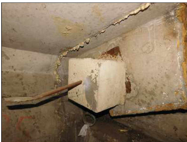
Koroze kotevního plechu.
