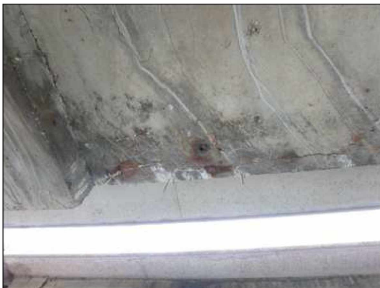
Zatékání na okraj konzoly pod římsou - výluhy a průsaky koroze.
