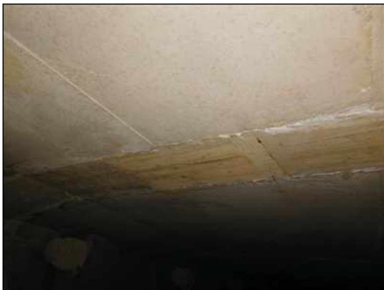
Výluhy v místě uzavírací spáry na podhledu horní desky v dutině nosné konstrukce.
