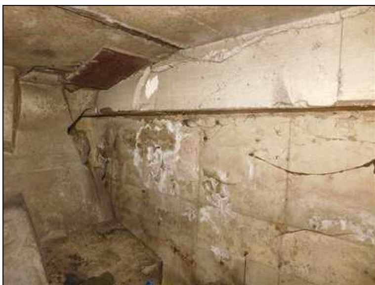
Výluhy a výkvěty na závěrné zídce opěry 1.
