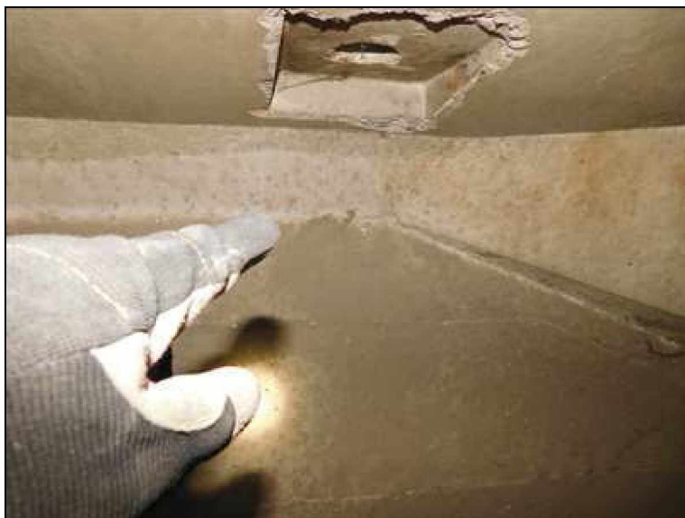
Trhlina mezi horní deskou a boční stěnou.
