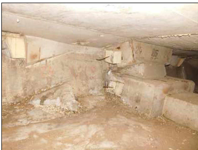
Pohled na prostor u nadpodporového příčniku nad pilířem - nečistoty.
