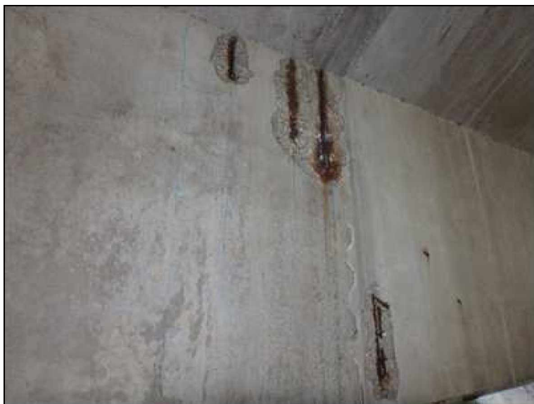
Lokálně obnažená korodující betonářská výztuž na boku nosné konstrukce.
