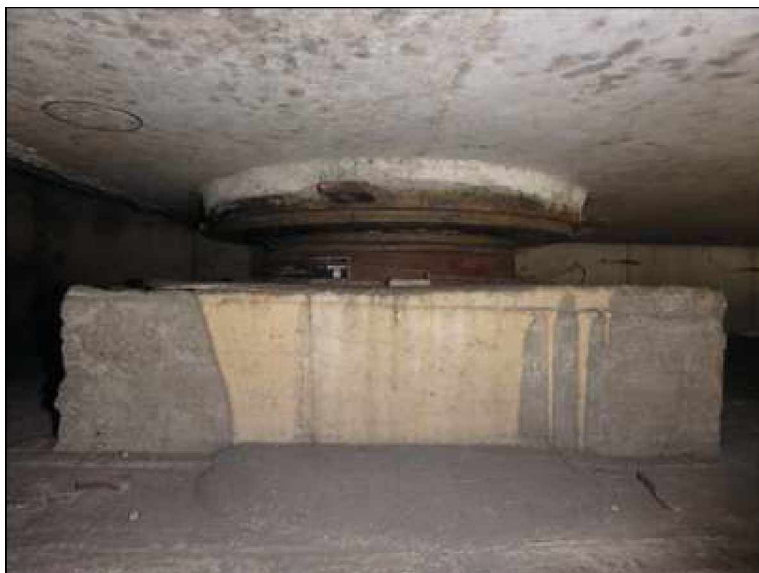
Levé ložisko na opěře 4 - koroze.
