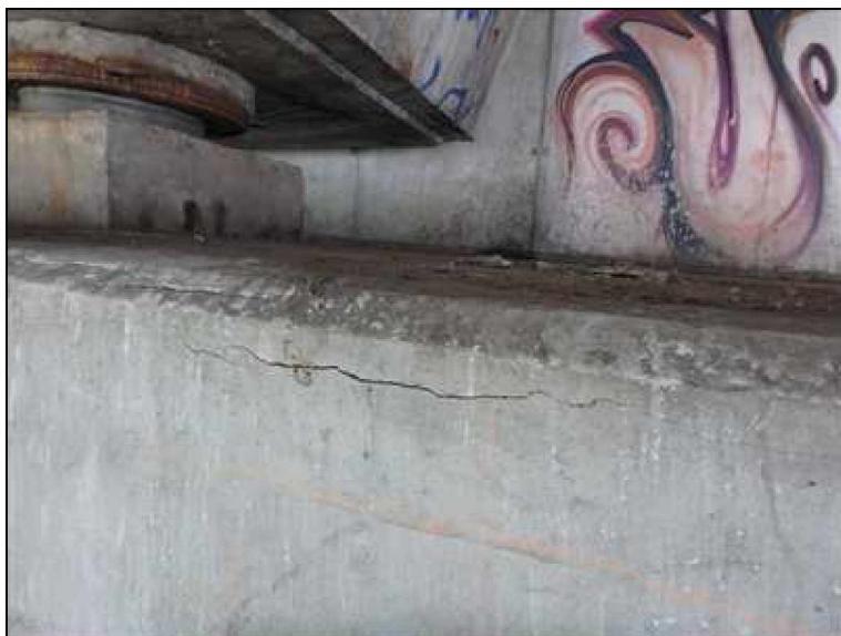
Vodorovná trhlina v horní hraně opěry 1.
