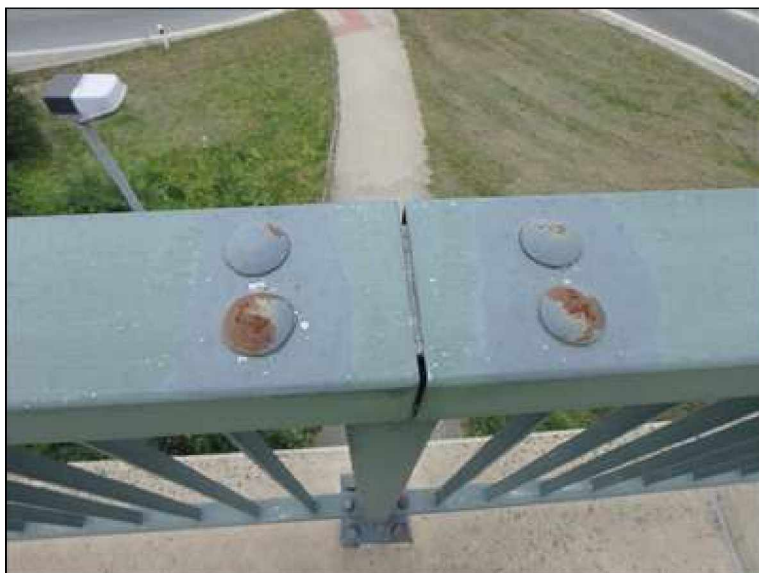
Povrchová koroze spojovacího materiálu záchytného systému.
