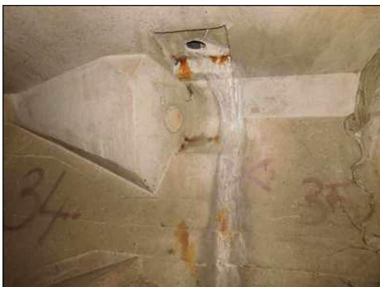
Zatékání s výluhy v oblasti otvoru v horní desce nosné konstrukce v dutině. Pravděpodobně neaktivní.
