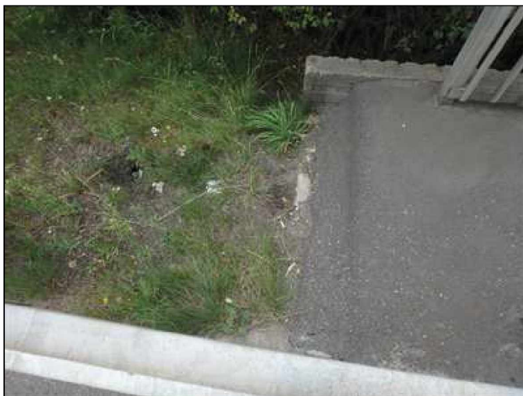
Eroze svahu za mostem vpravo.
