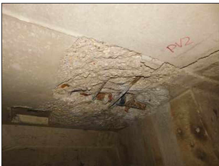
V místě separace krycí betonové vrstvy v horní desce nosné konstrukce. Po snadném odbourání v rámci průzkumu je obnažená předpínací výztuž. Chránička koroduje. Závada je v poli 1 vlevo u pilíře 2 v dutině nosné konstrukce.
