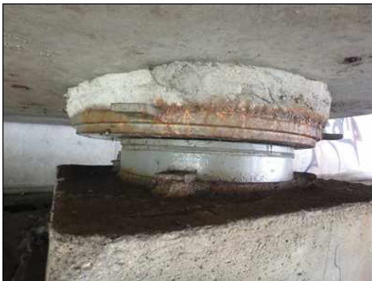
Levé ložisko na opěře 1.
