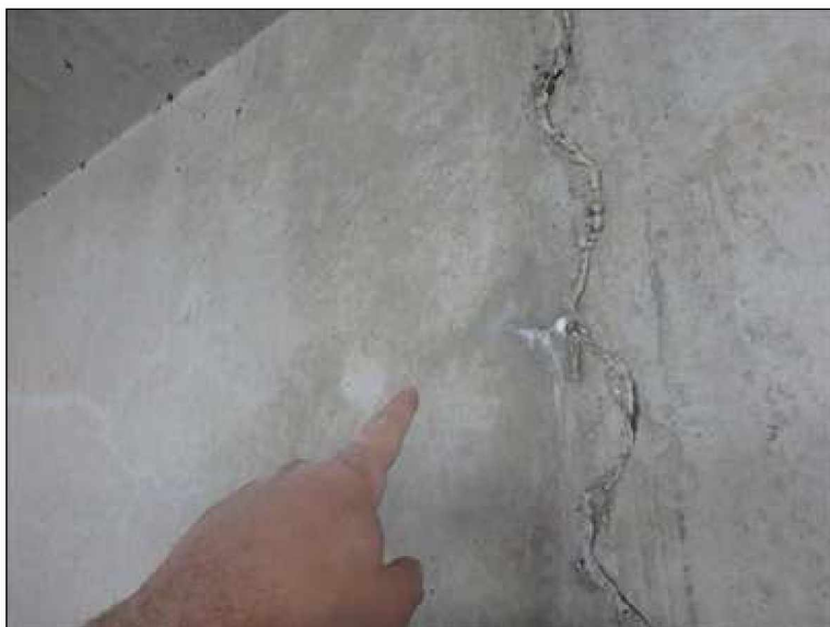
Trhlina s výluhem na boku nosné konstrukce.
