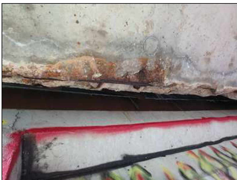
Obnažená korodující betonářská výztuž v koncové hraně nosné konstrukce nad opěrou 1.
