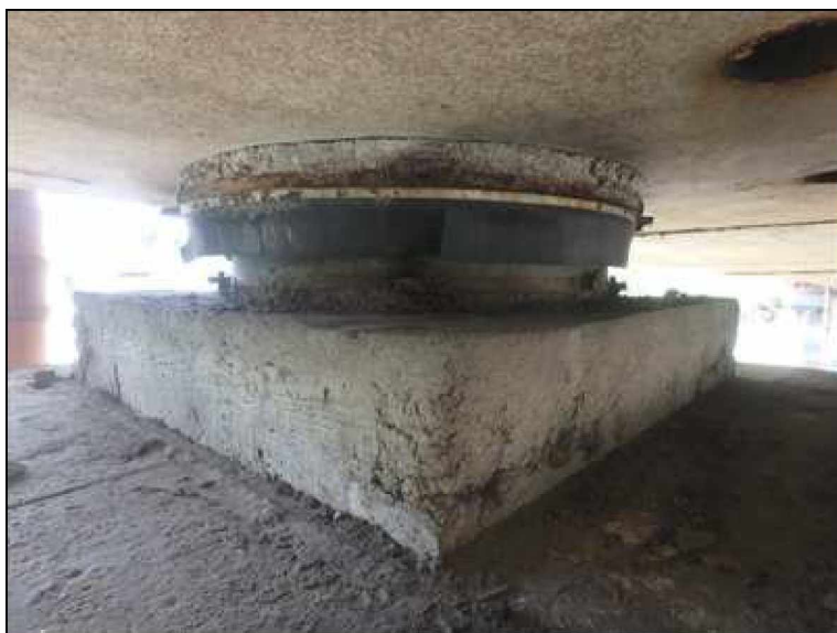
Pravé ložisko na pilíři 3.
