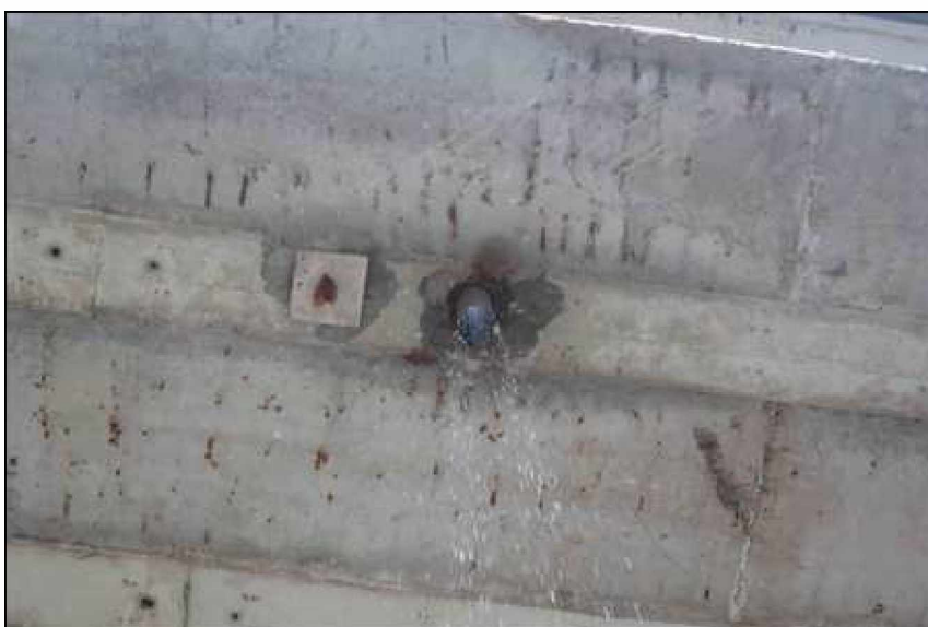
průsak v okolí svodu odvodnění v 9. poli
