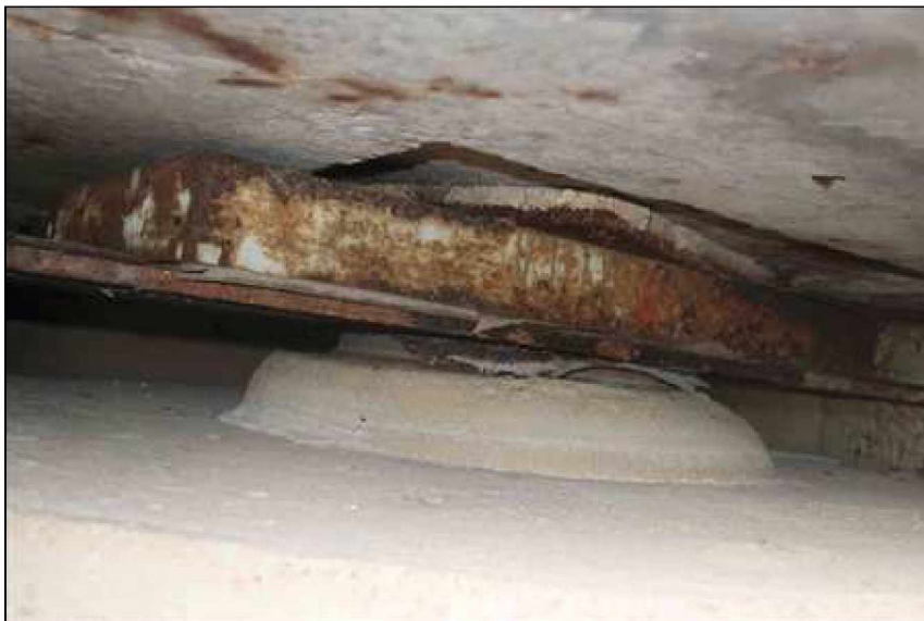
intenzivní koroze chybně nastaveného ložiska na O13
