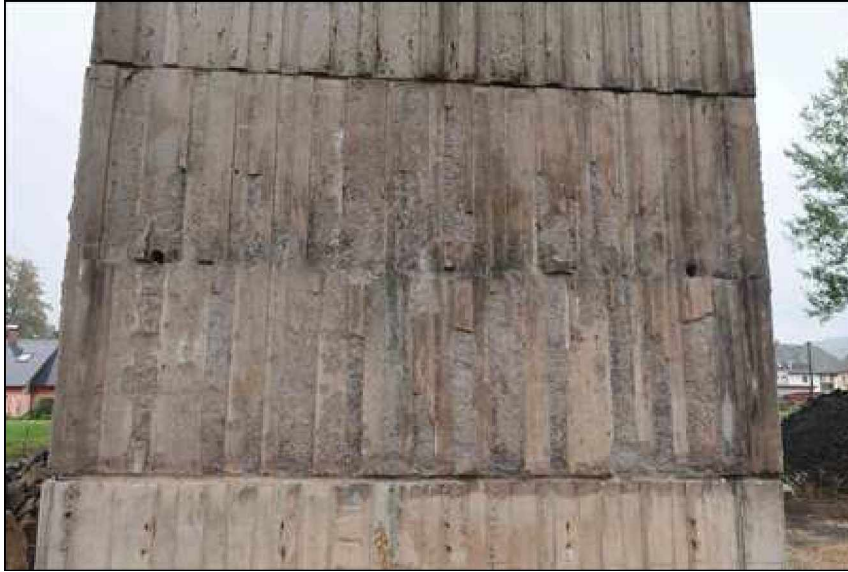
líc prefabrikátů ztraceného bednění pilíře 7 je poškozen ohněm
