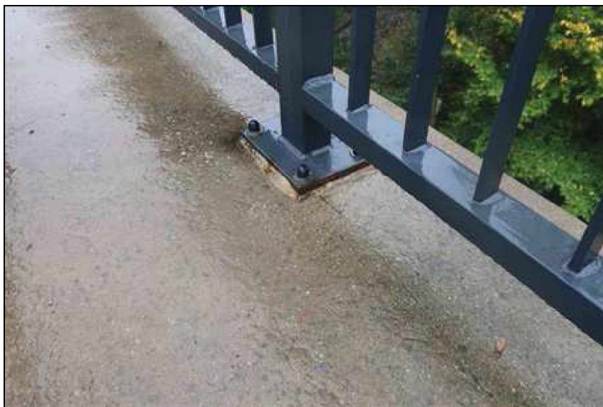
koroze patního plechu sloupku zábradlí
