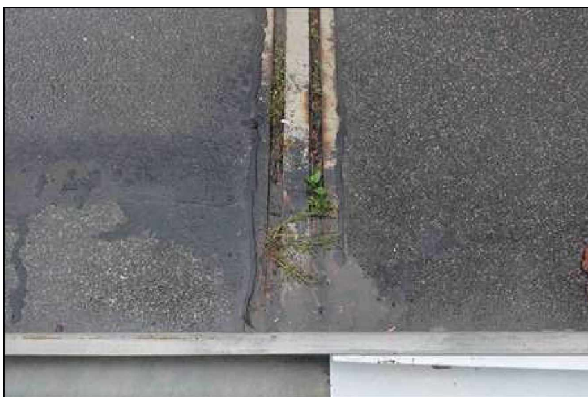
DTTO - částečně zanesené těsnící profily MZ
