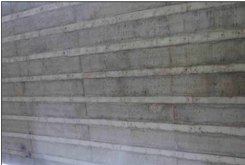
typický stav spodního líce nosné konstrukce
