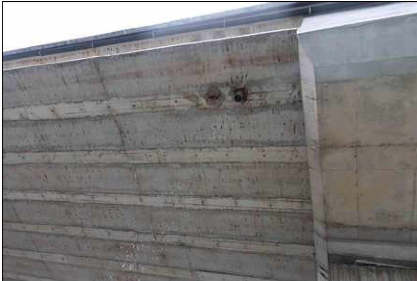
průsak v okolí svodu odvodnění v 10. poli
