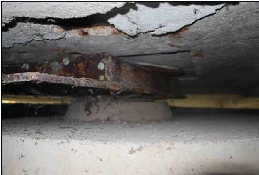
DTTO + koroze kotvy předpinací výztuže nosníku pod odpadlým krytím
