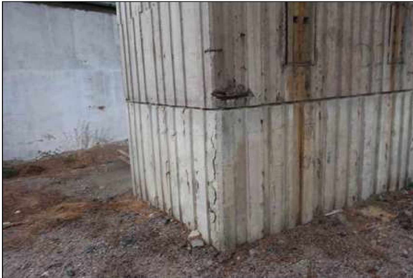
separace krycí vrstvy nad korodující výztuží na lici prefabrikátu ztraceného bednění na lici pilíře
