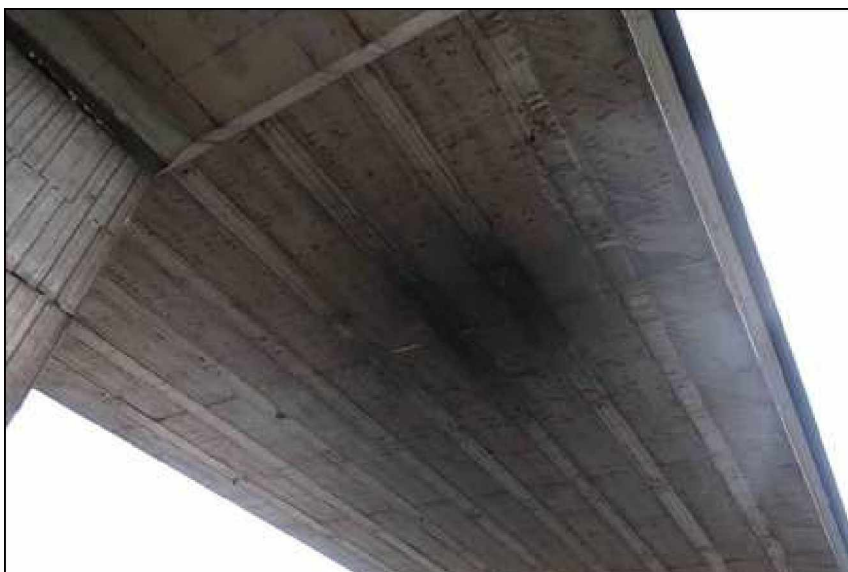
nad budovou v 11. poli je znečištěný pohled NK kouřovými zplodinami
