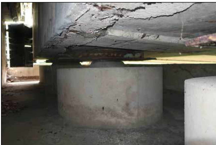
koroze ložisek na opěře 1, která jsou špatně nastavena
