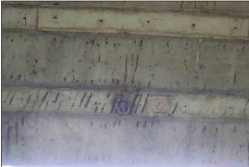
stopy po průsaku a zvýšená koroze výztuže spáry mezi nosníky v okolí svodu odvodnění
