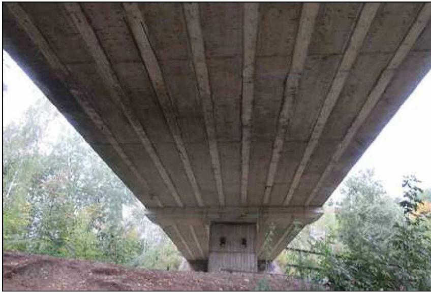
podhled nosné konstrukce je ve 2. poli nad železniční tratí znečištěn kouřovými zplodinami
