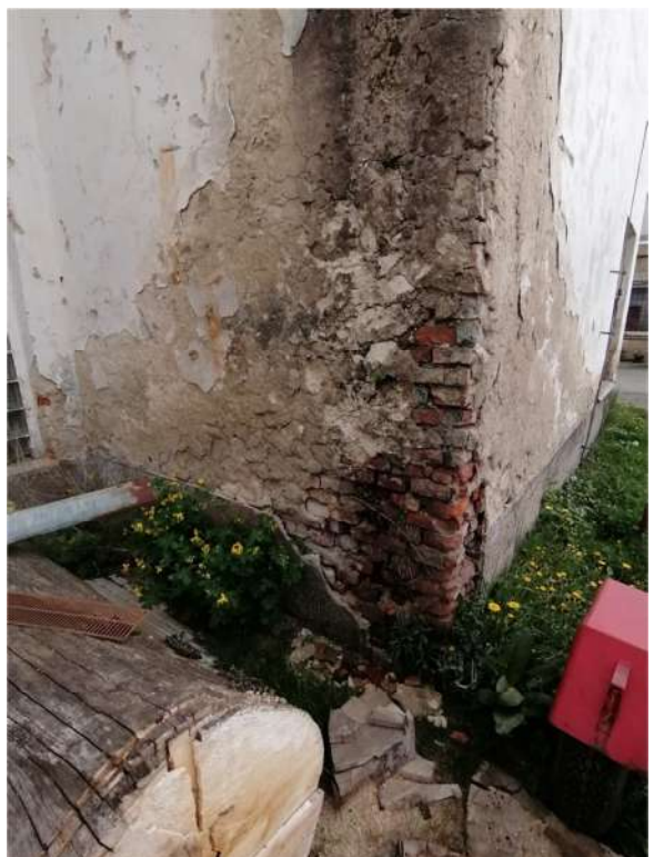
Obr.22: Lokální výtluky v nosné stěně části A2
