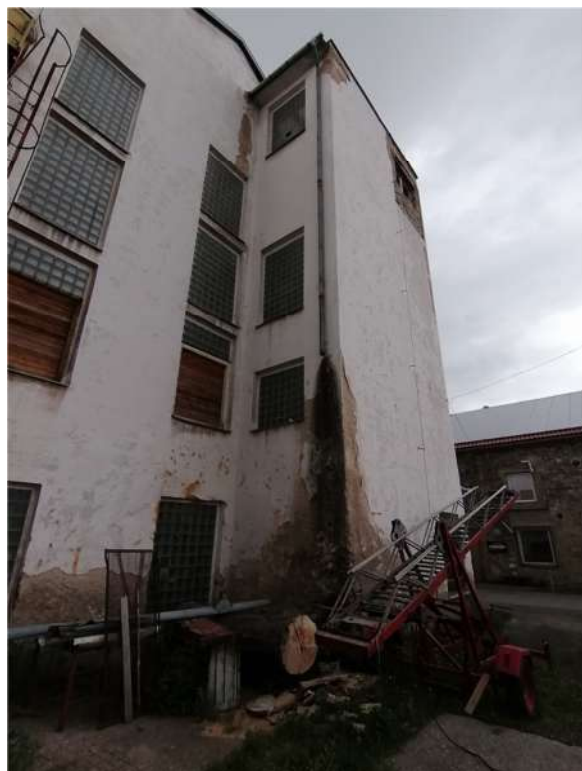
Obr.23: Lokální výtluky v nosné stěně části A2
