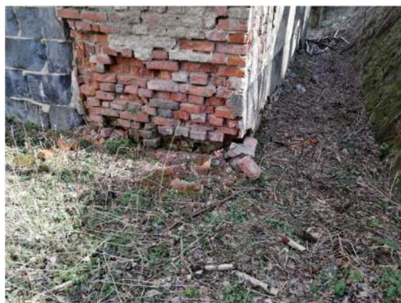
Obr.17: Lokální výtluky v nosné stěně části A3
