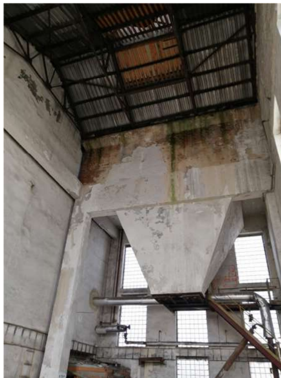
Obr.15: Nefunkční odvodnění střešního pláště v části A1
