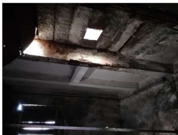
Obr.31: Chybějící krycí vrstva betonu a korodující výztuž
