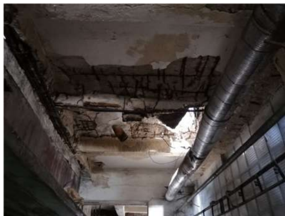
Obr.35: Chybějící krycí vrstva betonu a korodující výztuž
