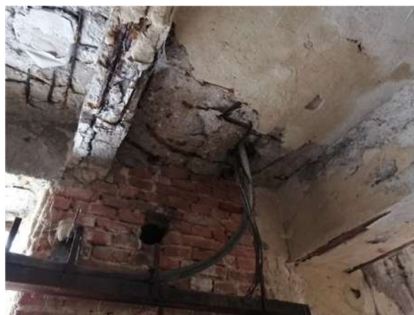
Obr.39: Chybějící krycí vrstva betonu a korodující výztuž
