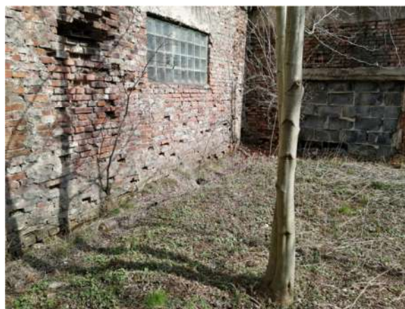
Obr.19: Lokální výtluky v nosné stěně části A1 a B
