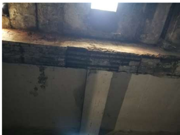
Obr.32: Chybějící krycí vrstva betonu a korodující výztuž
