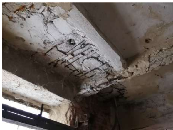
Obr.38: Chybějící krycí vrstva betonu a korodující výztuž
