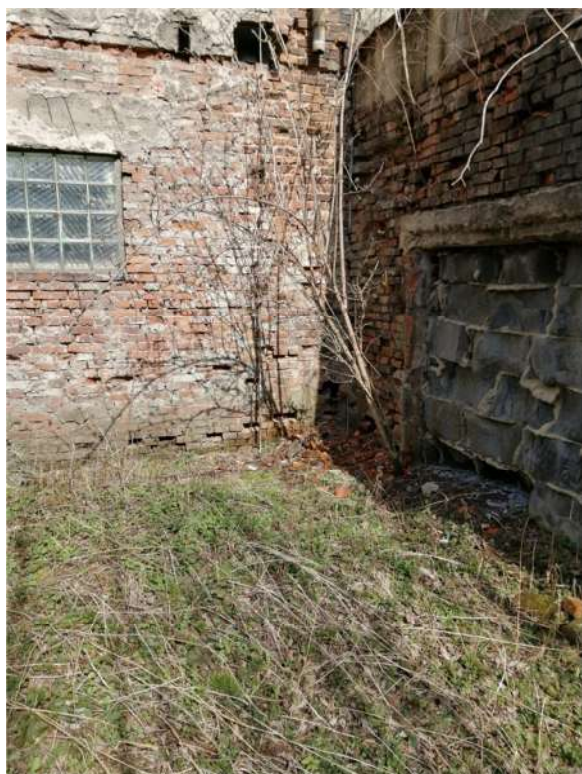
Obr.11: Roh stěny mezi částmi A1 a A3 – stěny z plných cihel a zadržka otvoru z plynosilikátových tvárníc
