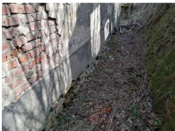
Obr.16: Lokální výtluky v nosné stěně části A3
