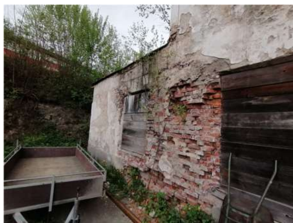
Obr.21: Lokální výtluky v nosné stěně části A1 a A3
