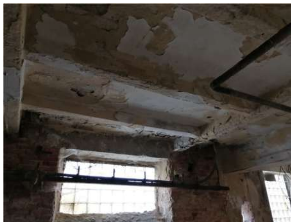
Obr.37: Nabobtnaná krycí vrstva betonu
