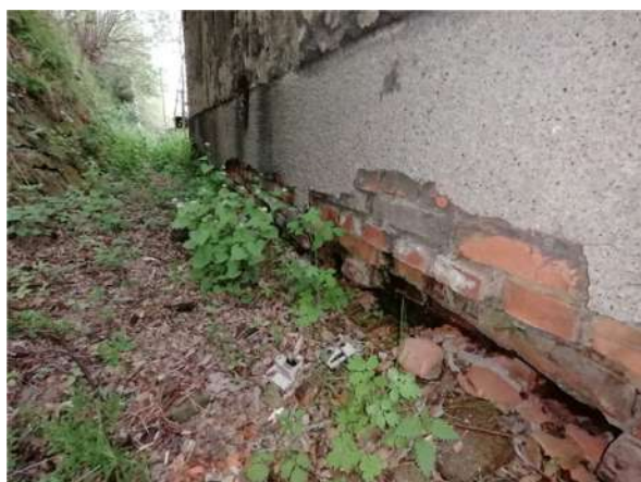
Obr.20: Lokální výtluky v nosné stěně části A3
