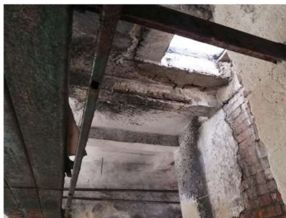
Obr.33: Chybějící krycí vrstva betonu a korodující výztuž
