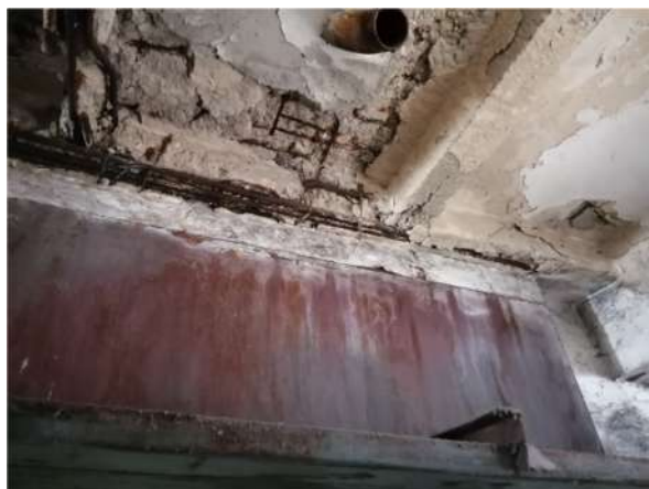
Obr.36: Chybějící krycí vrstva betonu a korodující výztuž
