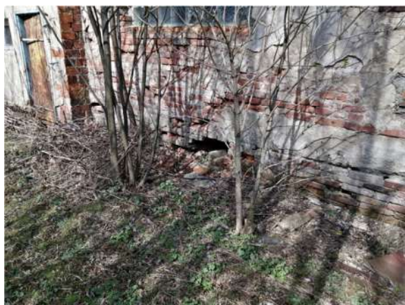
Obr.18: Lokální výtluky v nosné stěně části B
