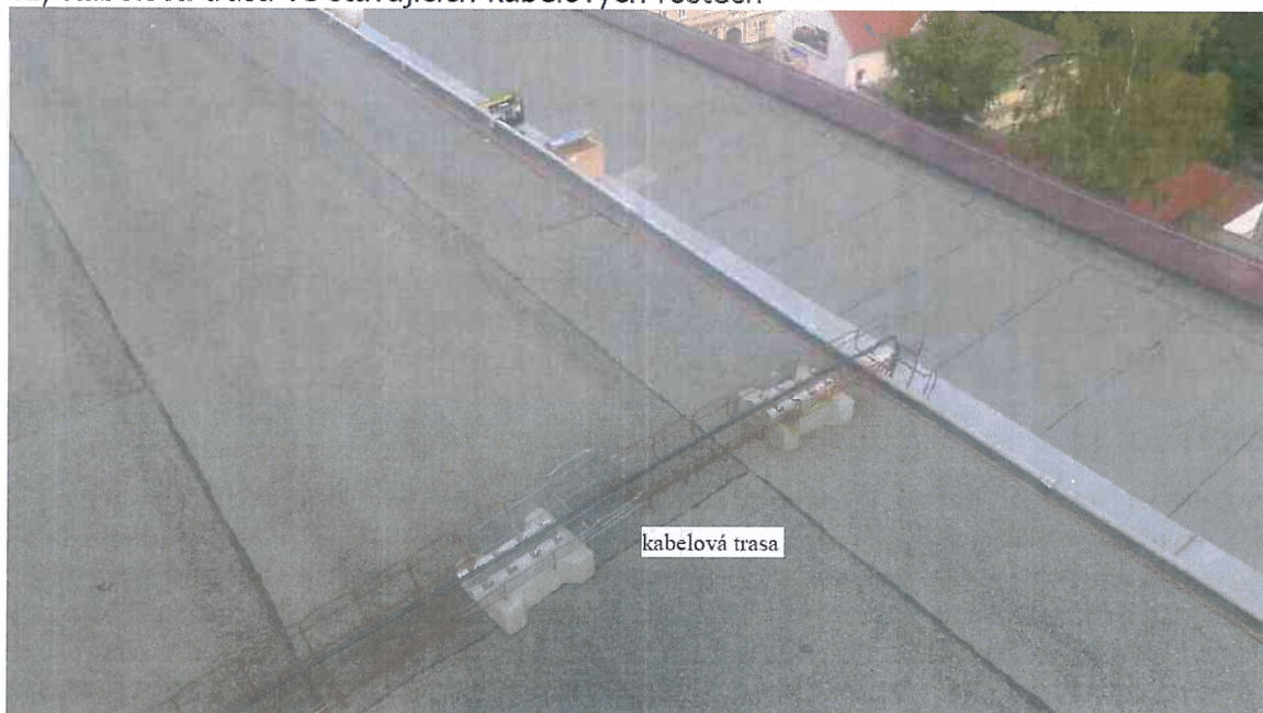
Obr. č.3, Kabelová trasa ve stávajících kabelových roštech
