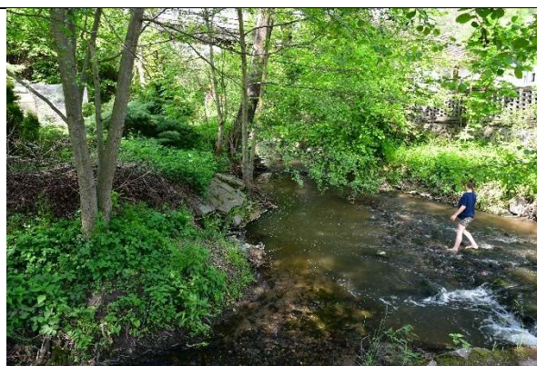
Obr 37 - Soutok Zákolanského a Týneckého potoka v Zákolanech v blízkosti městského parku s viditelně poškozeným opevněním – dlažba je zřejmě po poslední povodni poškozena.
