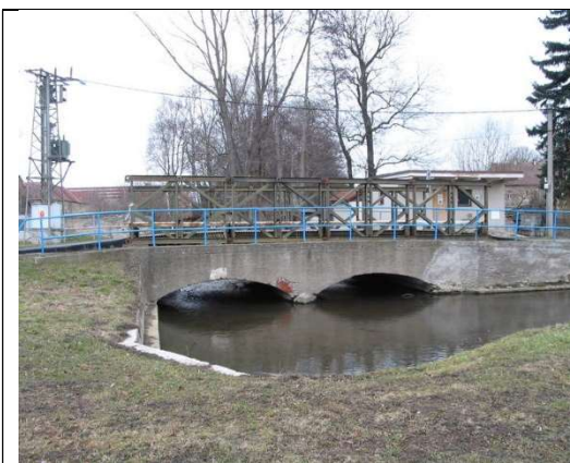
Obr. č. 3 Klasická povodňová překážka – most ve Velkých Číčovicích. Výstavba nového, kapacitního mostu nebyla realizována, pouze byla opravena mostovka, ale podélná osa toku zůstala beze změny
