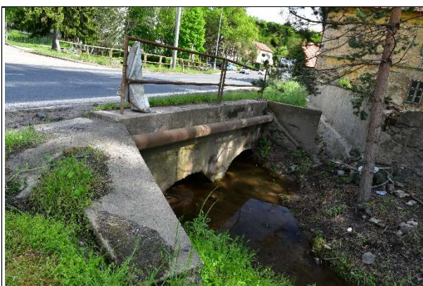
Obr 44 - Turský potok – propustek pod státní silnicí nad Prahu – propustek je v žalostném technickém stavu a jeho okolí plné odpadu
