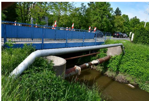
Obr 48 - Zákolanský potok – mosty a infrastruktura překážkou povodňových průtoků těsně před soutokem s Knovízským potokem - potrubí prochází těsně nad běžně dosaženou hladinou
