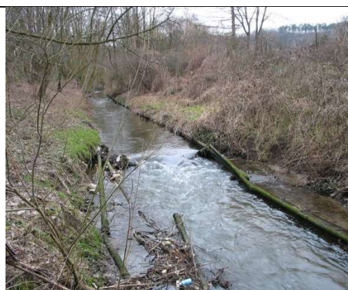
Obr. č. 6 Laťové plůtky, které v této zbytečné úpravě potoka tvořily opevnění kynety, se již místy rozpadají. To je příznivé, ale nepříznivé napřímení a zahloubení koryta to ovlivní jenom málo. Zde je třeba provést zásadnější revitalizaci.
