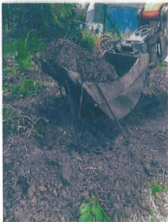
4.9.2020 Výkop základů křídlo JIH ( znečištění zbytky odpadů – komunál)
