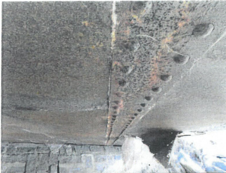
Výrazná důlková koroze hlavních nosníků a plechu mostovky. Stopy po zatékání zejména ve spárách mezi plechy mostovky.
