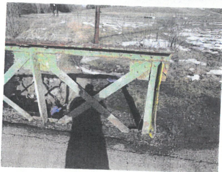
Deformovaná nepodporová svislice hlavního nosníku na povodní straně mostu.
