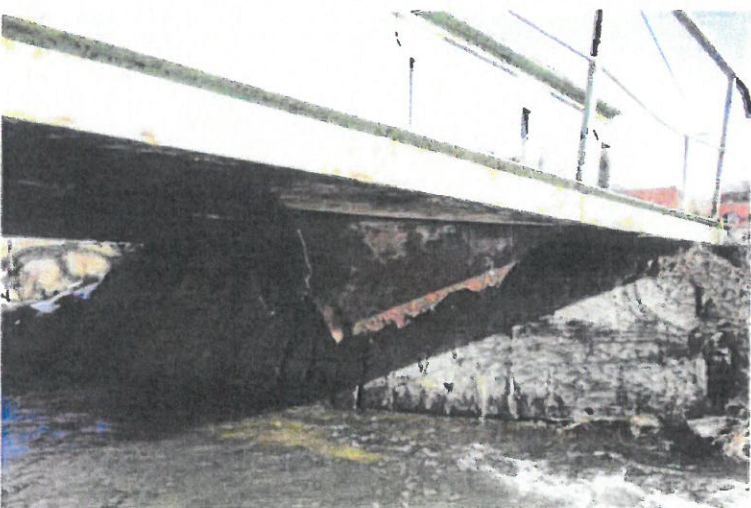
Degradace dolního ocelového plechu mostovky.
