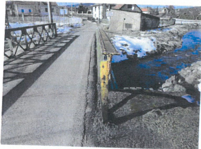
Deformovaná nepodporová svislice hlavního nosníku na povodní straně mostu.
