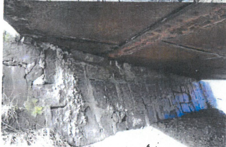
Výrazná důlková koroze hlavních nosníků, lístková koroze plechu mostovky. Stopy po zatékání zejména ve spárách mezi plechy mostovky.
