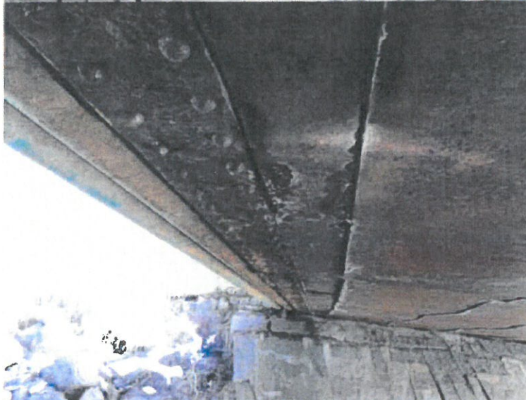
Výrazná důlková koroze hlavních nosníků a plechu mostovky. Stopy po zatékání zejména ve spárách mezi plechy mostovky.
