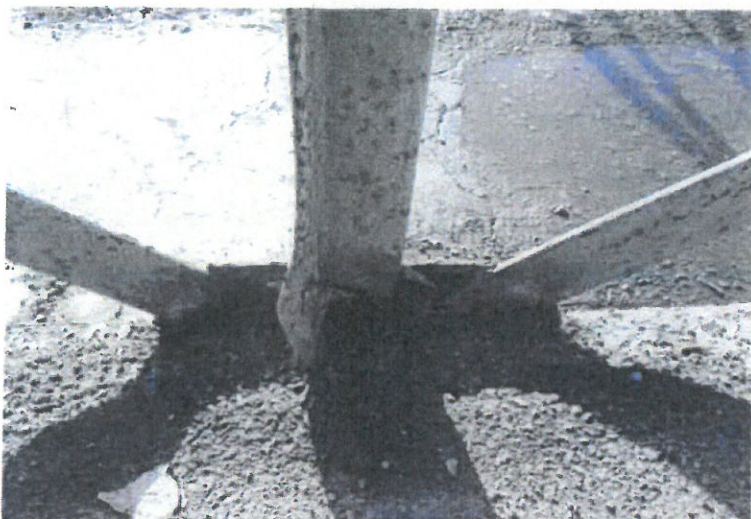
Deformovaný průřez svislice – častý detail.
