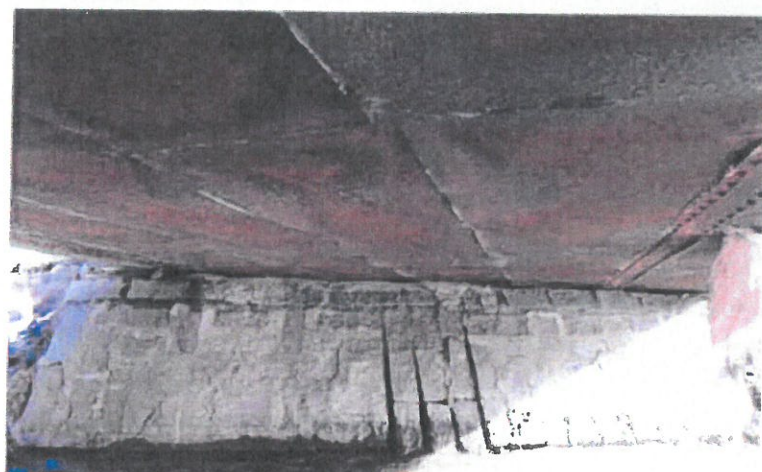
Výrazná důlková koroze hlavních nosníků, lístková koroze plechu mostovky. Stopy po zatékání zejména ve spárách mezi plechy mostovky.
