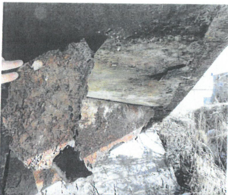
Degradace dolního ocelového plechu mostovky.
