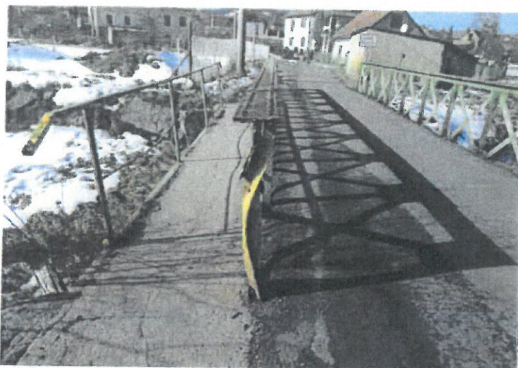
Degradovaná nadpodporová svislice hlavního příhradového nad pravoběžní opěrou.
