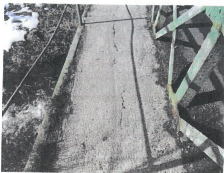
Degradovaná spára mezi krajním hlavním nosníkem a betonovou mostovkou chodníku. Koroze krajního ocelového nosníku.
