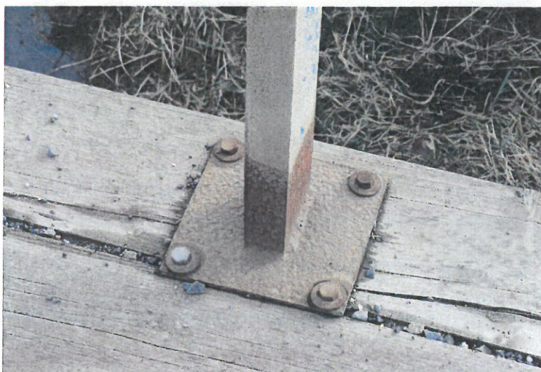
Koroze ocelových prvků svodidel.
