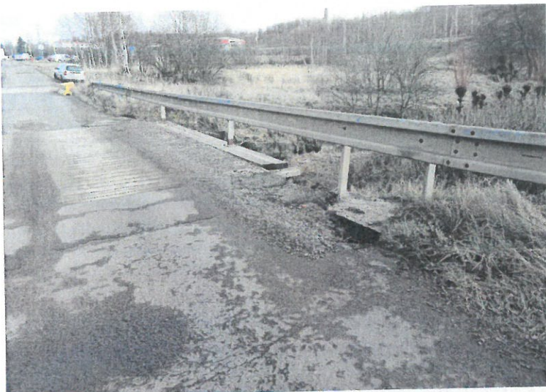
Kaverna v jihozápadním sektoru mostu.
