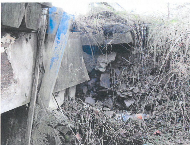
Detail sesuvu křídla v severozápadním sektoru mostu.
