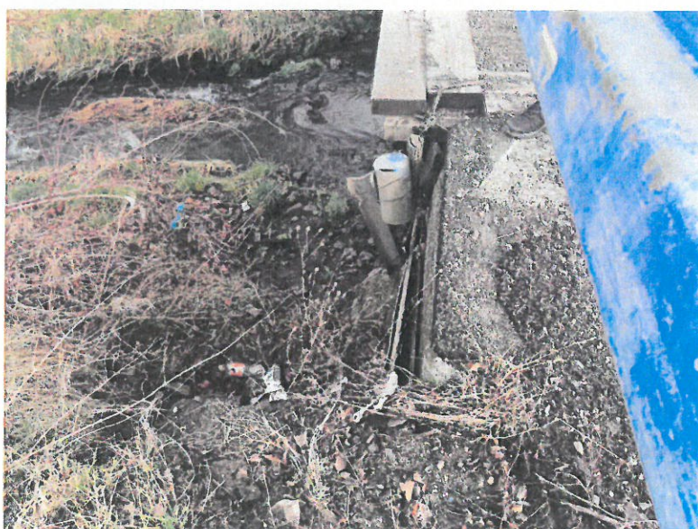
Sesuv křídla v severozápadním sektoru mostu.
