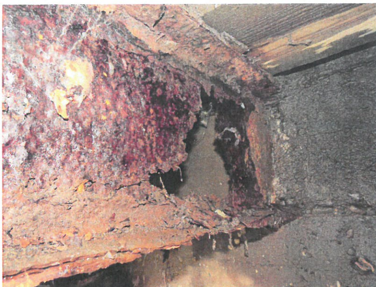
Díry ve stěně nosníku I260 způsobené výrazným korozním oslabením.
