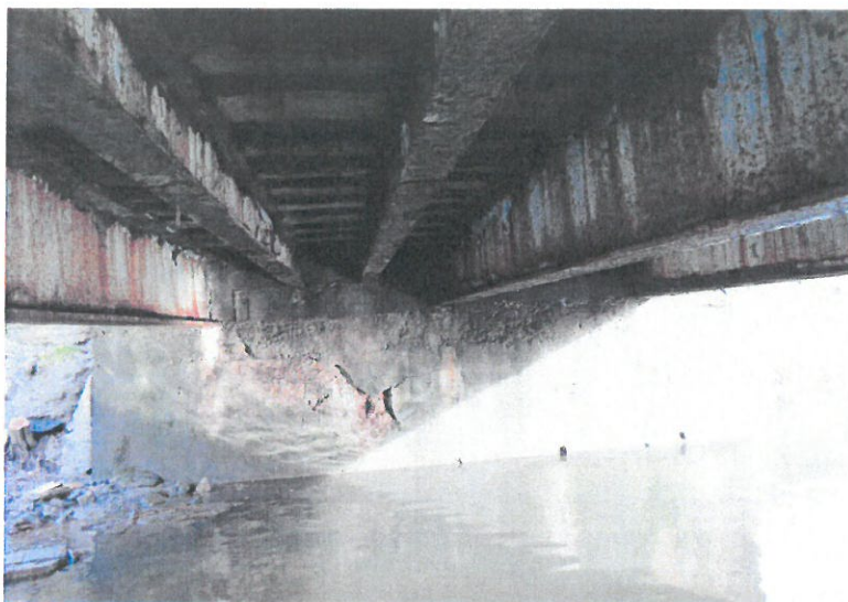
Levobřežní opěra, degradace povrchu. Koroze nosné konstrukce.
