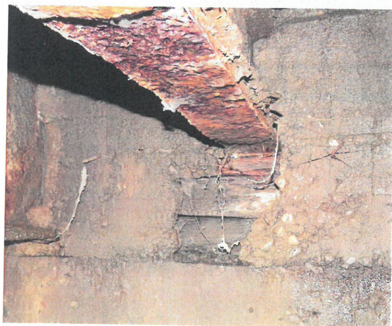
Odpadlý beton pod nízkým nosníkem levobřežní opěry.
