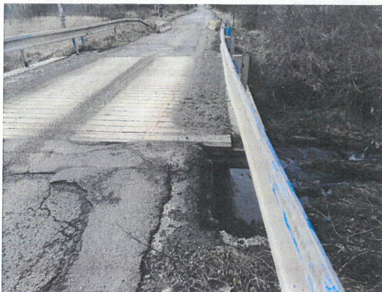
Detail kaverny v severo-východním sektoru mostu.
