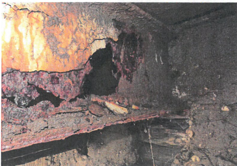
Díry ve stěně nosníku I260 způsobené výrazným korozním oslabením.
