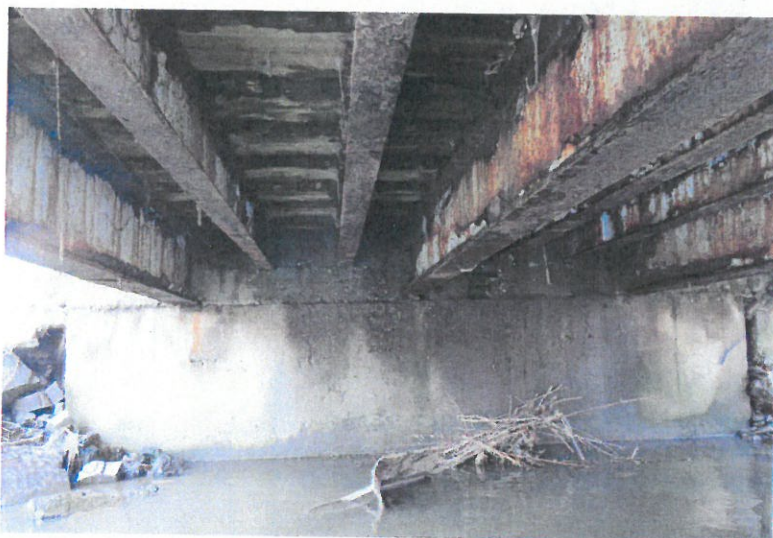
Podhled nosné konstrukce, koroze ocelových prvků NK, zatékání spárami mezi dřevěnými trámy. Pravobřežní opěra.
