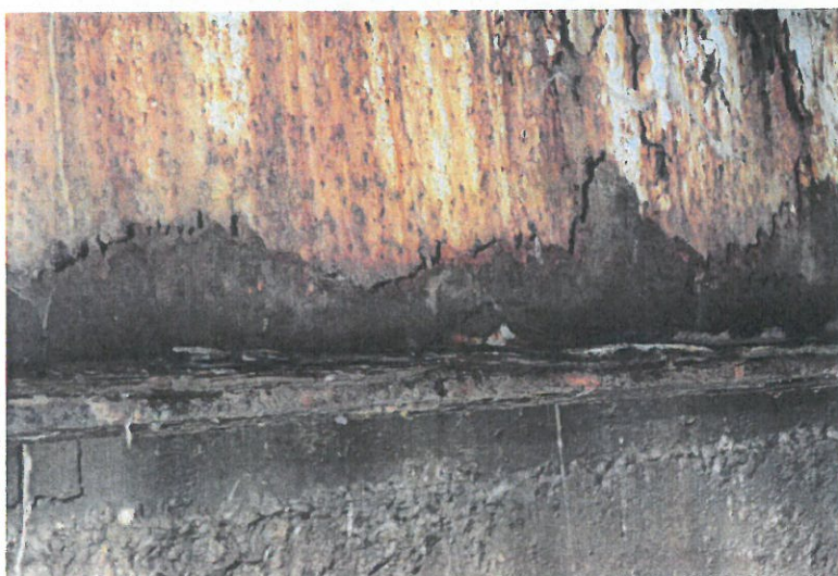
Oslabení dolní pásnice hlavního nosníku vlivem koroze.
