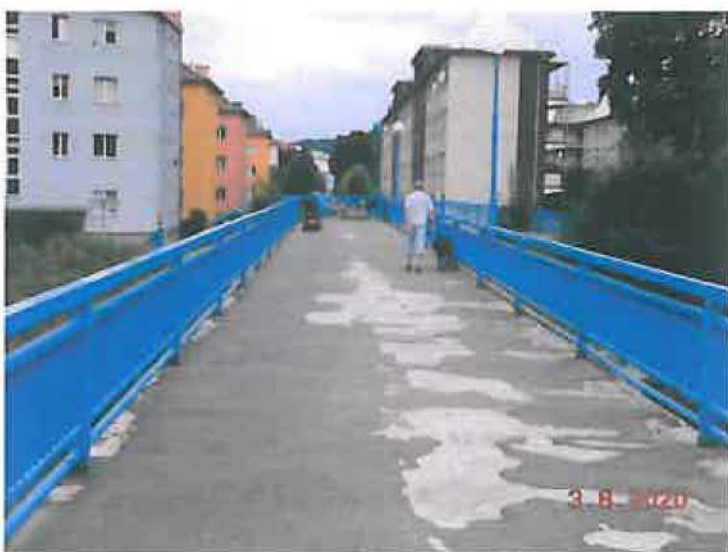
Další detail pochůzí plochy - dále se rozšiřuje poškození výtlučky a rozsáhle se plošně droří.
