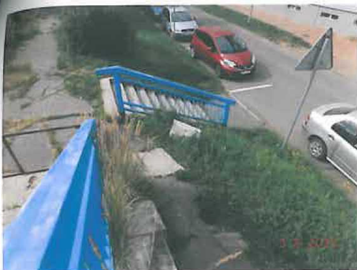
Detail na NK - rozpad betonu řims u ramp a schodišť, od ul. Sušilova.
