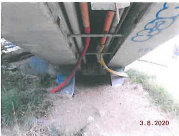
Pohled na PB opěru a NK, u opěry chybí záklop (POROROŠŤ), dtto druhá strana.
