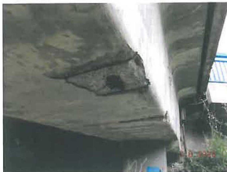
Detail na NK - trhlinky v omítce, lokální separace krycí vrstvy betonu, koroze výztuže.
