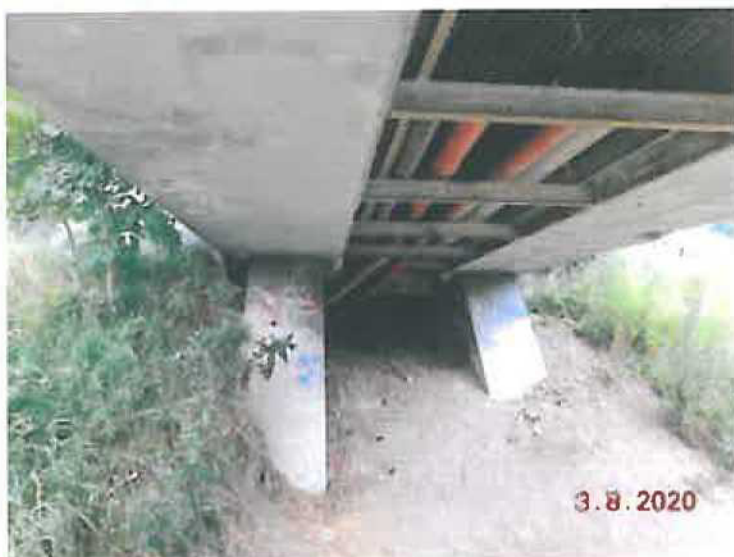
Pohled na LB opěru a NK, u opěry je sesunutě a splavené zemní těleso.
