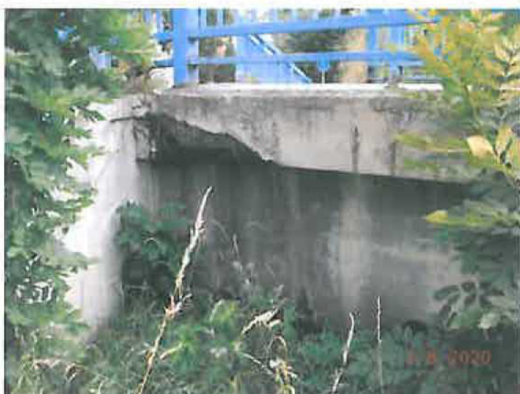
Další pohled na římsu lávky z ulice Sušilova - separace krycí vrstvy betonu, koroze výztuže.
