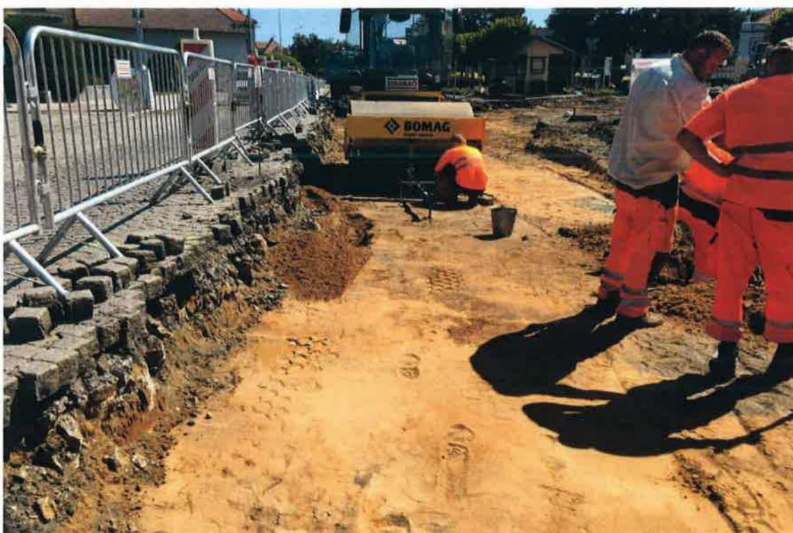
Provádění SZZ - únosné podloží - neprovádění zlepšení zeminy
