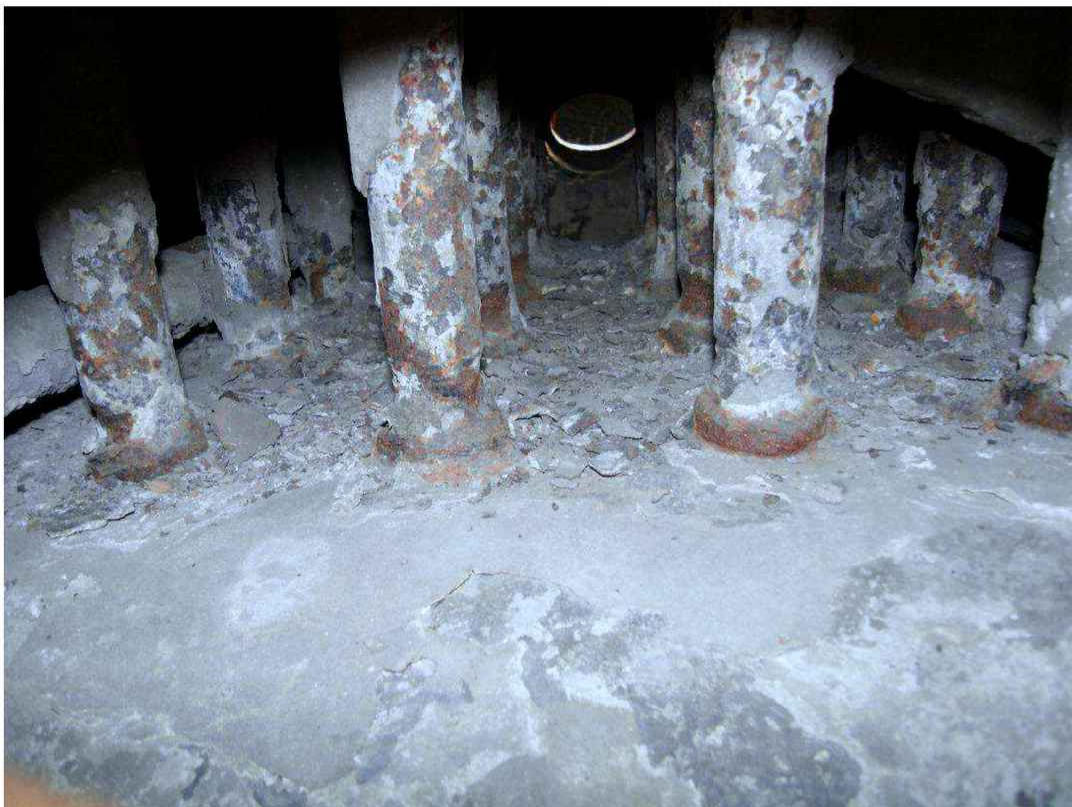
Obr. 20 Strop topeniště zanesený kotelním kamenem.
