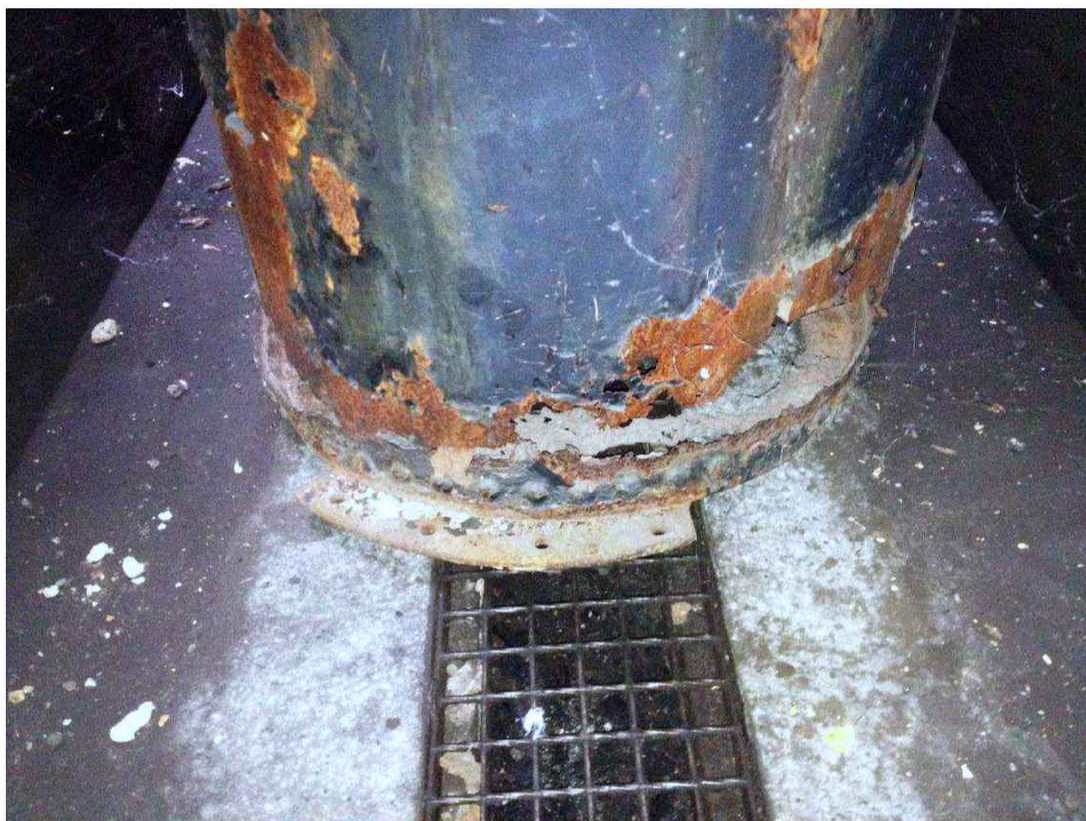
Obr. 50 Děravá čelní stěna L vodní vany.
