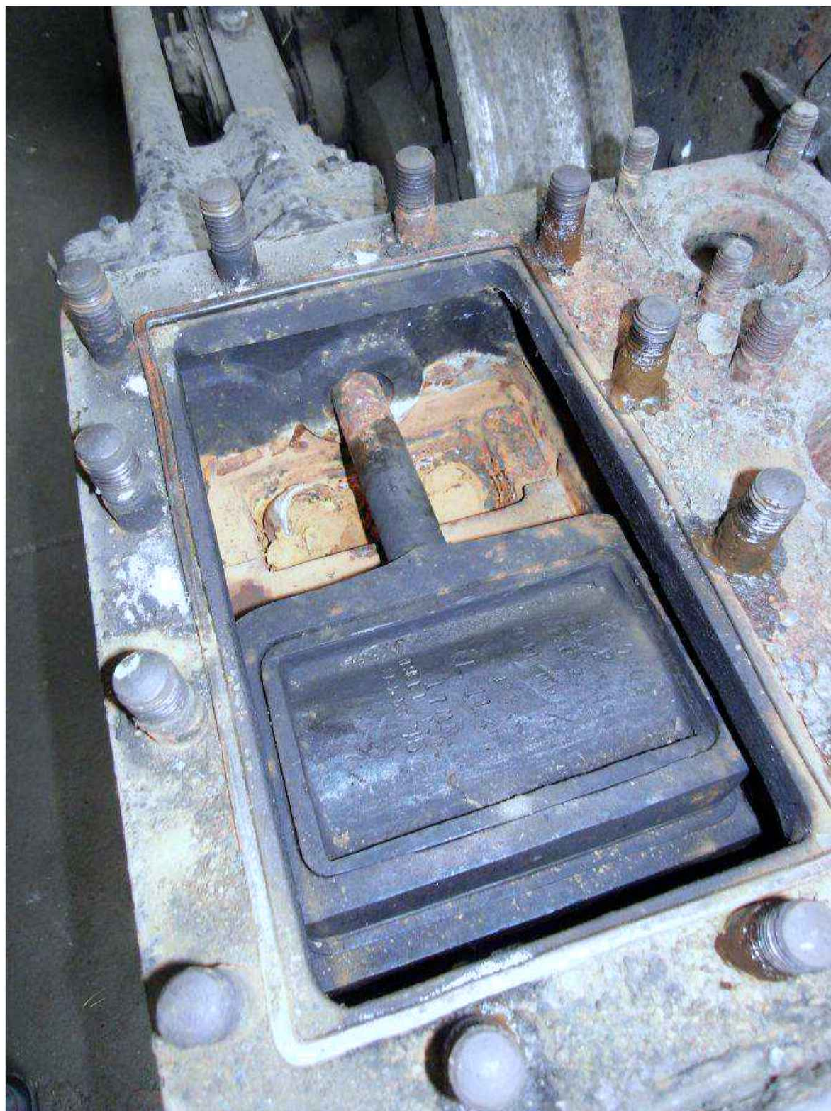
Obr. 32 Znečištění P šoupátkové komory korozními produkty.
