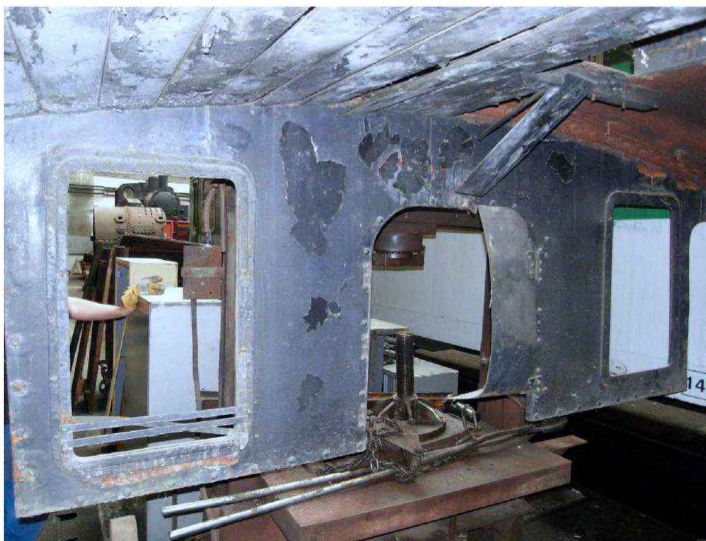
Obr. 59 Vnitřní pohled na zadní stěnu budky s pevnými okny a manipulačním otvorem, jehož uzávěr je nekompletní. Pod stropem torzo výdřevy.
