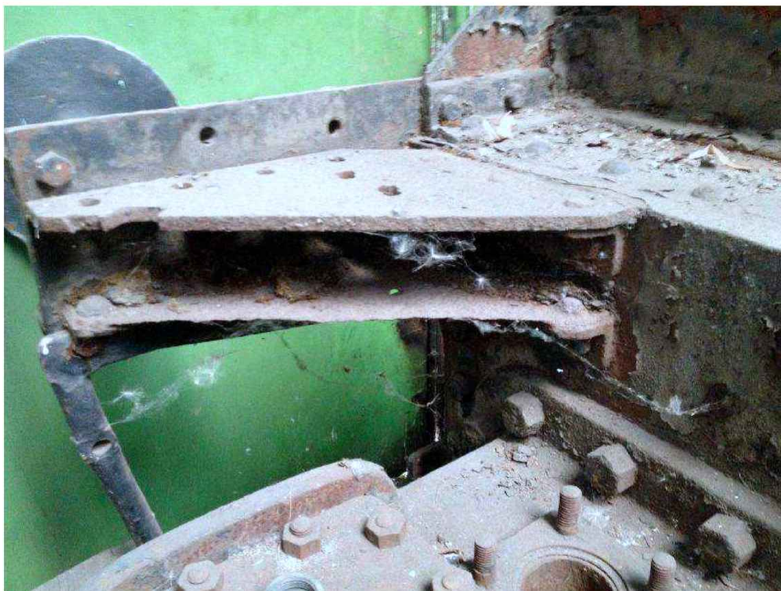
Obr. 40 Výztuhy za čelníky – horní v původní tloušťce a dolní zničená korozí.
