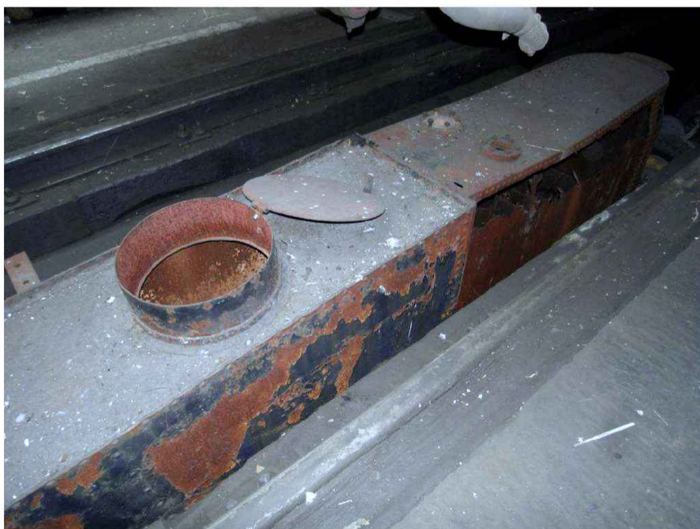
Obr. 49 Vodní vany jsou pro úsporu místa nyní uloženy v jámě pod vozidly. V pozadí je P vana, jejíž bok je již zcela rozpadlý. Stav druhé vany je tentýž.
