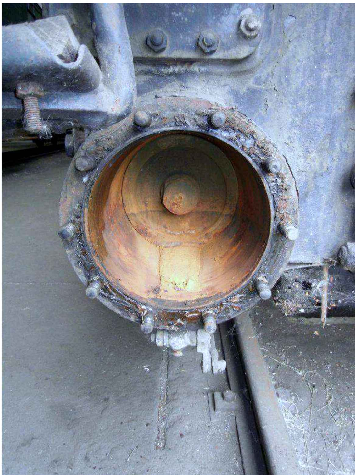
Obr. 33 Dobře viditelné stopy po hladině vody, která se hromadila uvnitř P válce a dno zanesené kalem. Stěny válce však nevykazují hluboké korozní napadení.
