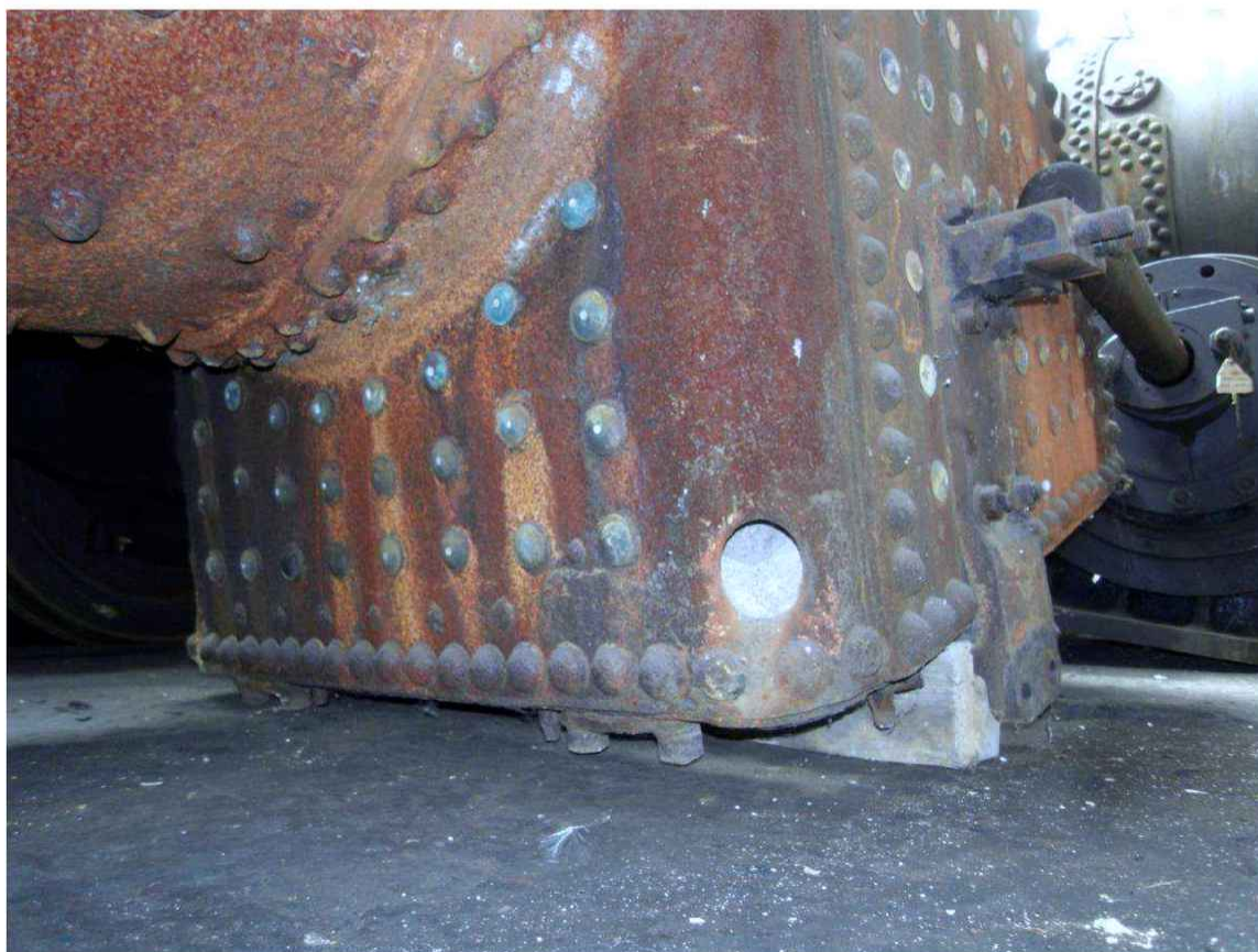
Obr. 19 Nožní rám zaplněný kotelním kamenem. Raková stěna postrádá otvor pro odkalovací kohout.
