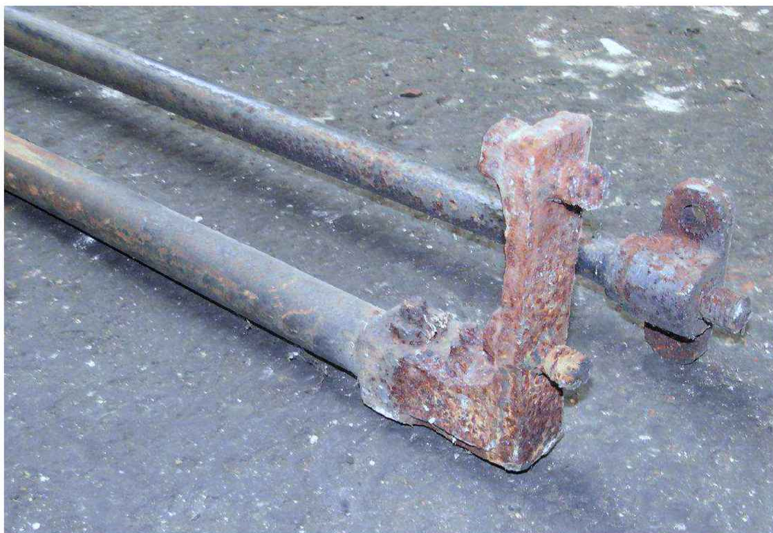
Obr. 56 Významný korozní úbytek materiálu na patce sloupku, který nese střechu budky.
