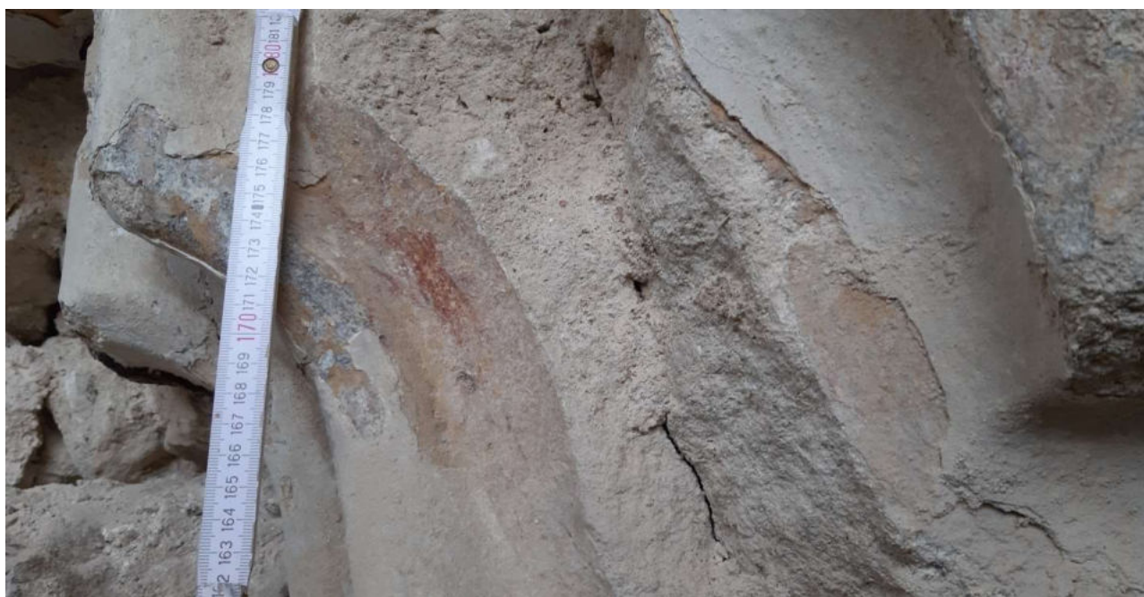
Kostel sv. Jakuba Kutná Hora Porta severní – „nálež“ Gotický sedlový portál, průběh vybourávání zadržky
