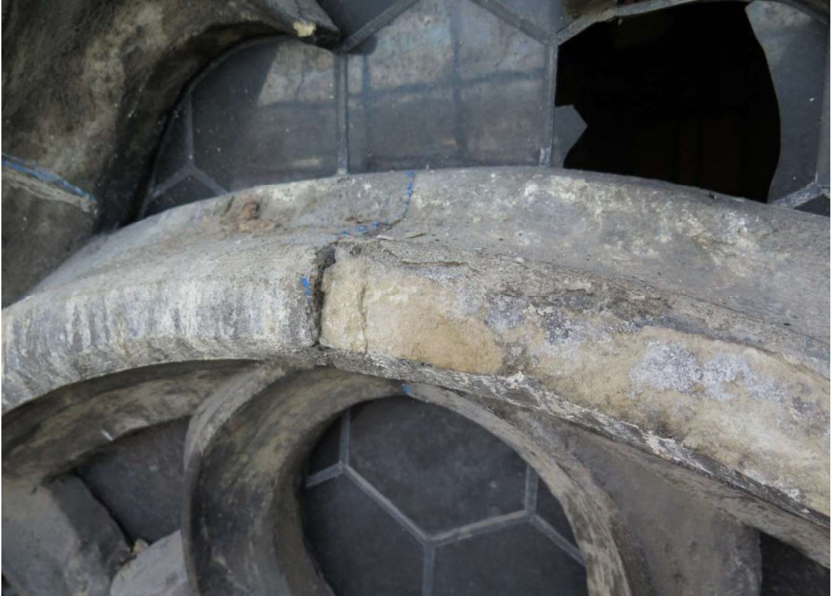
Detail poškození vrchní části kružby)
