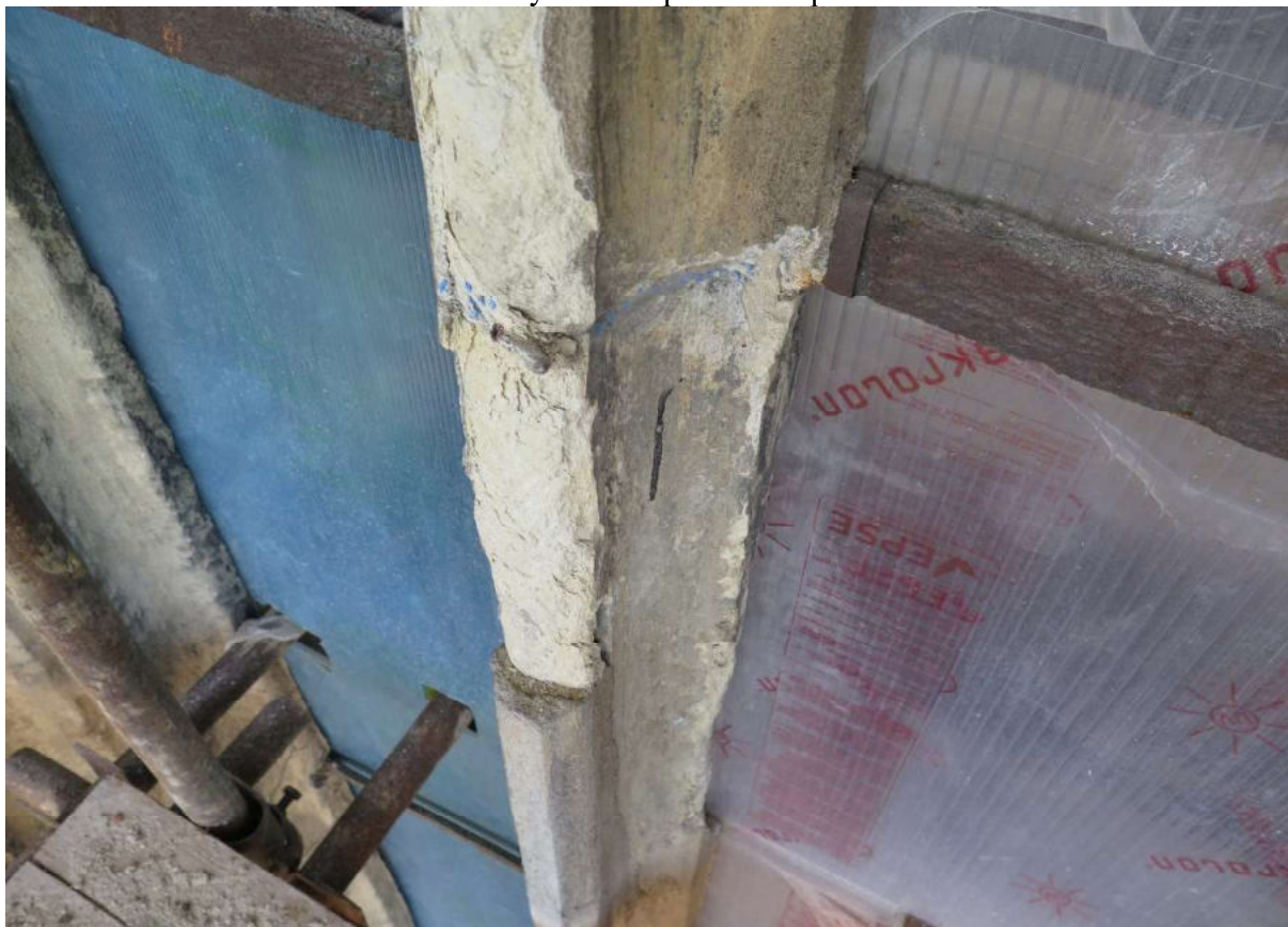
Detail výrazného poškození prutů
