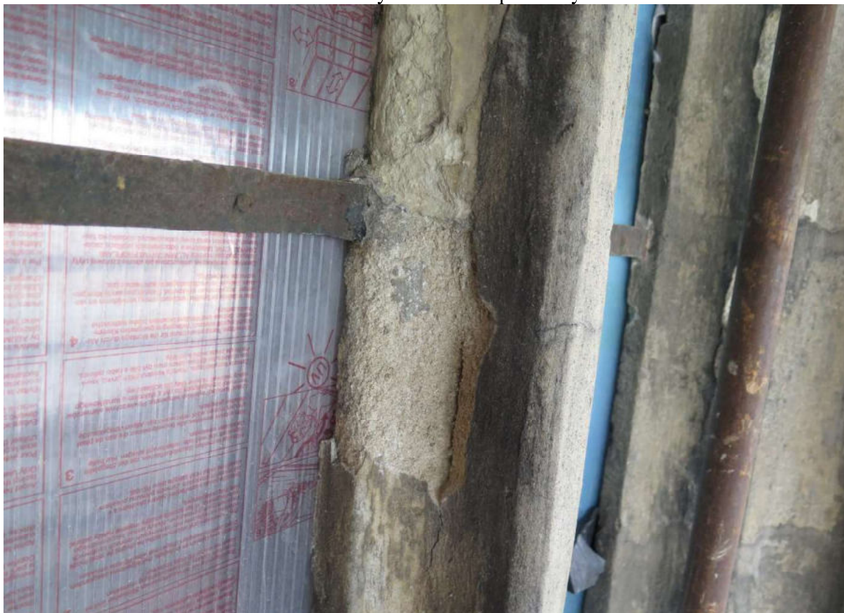
Pohled na výrazné svislé praskliny
