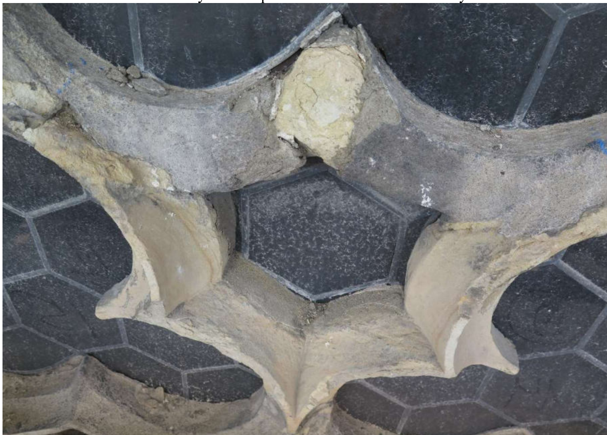
Detail výrazného poškození středové části kružby
