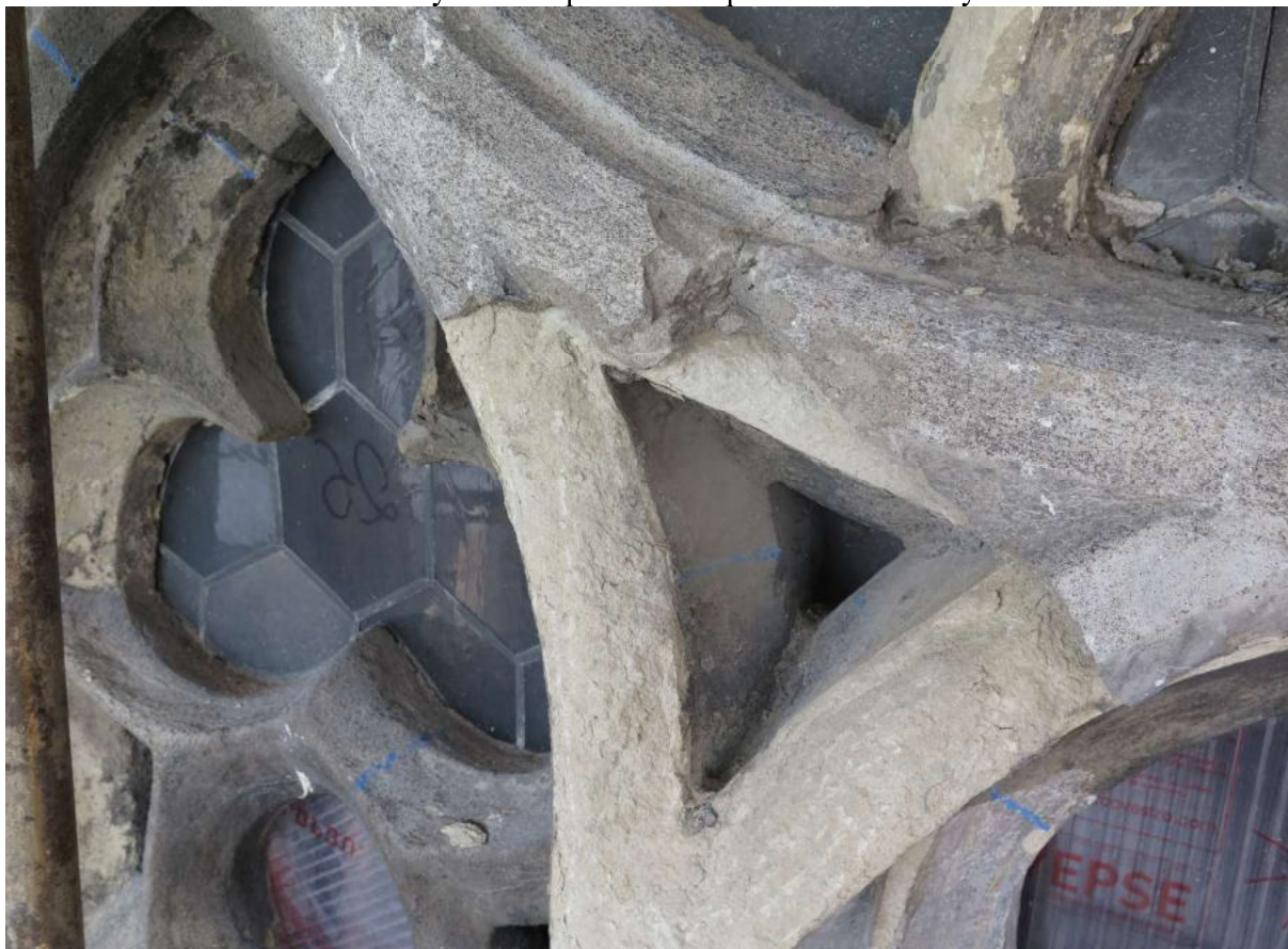
Detail výrazného poškození spodní části kružby
