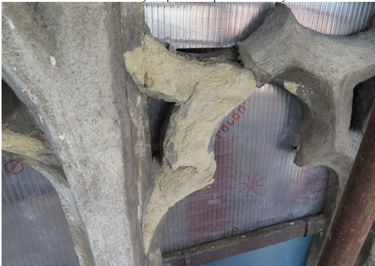
Detail havarijního poškození spodní části kružby
