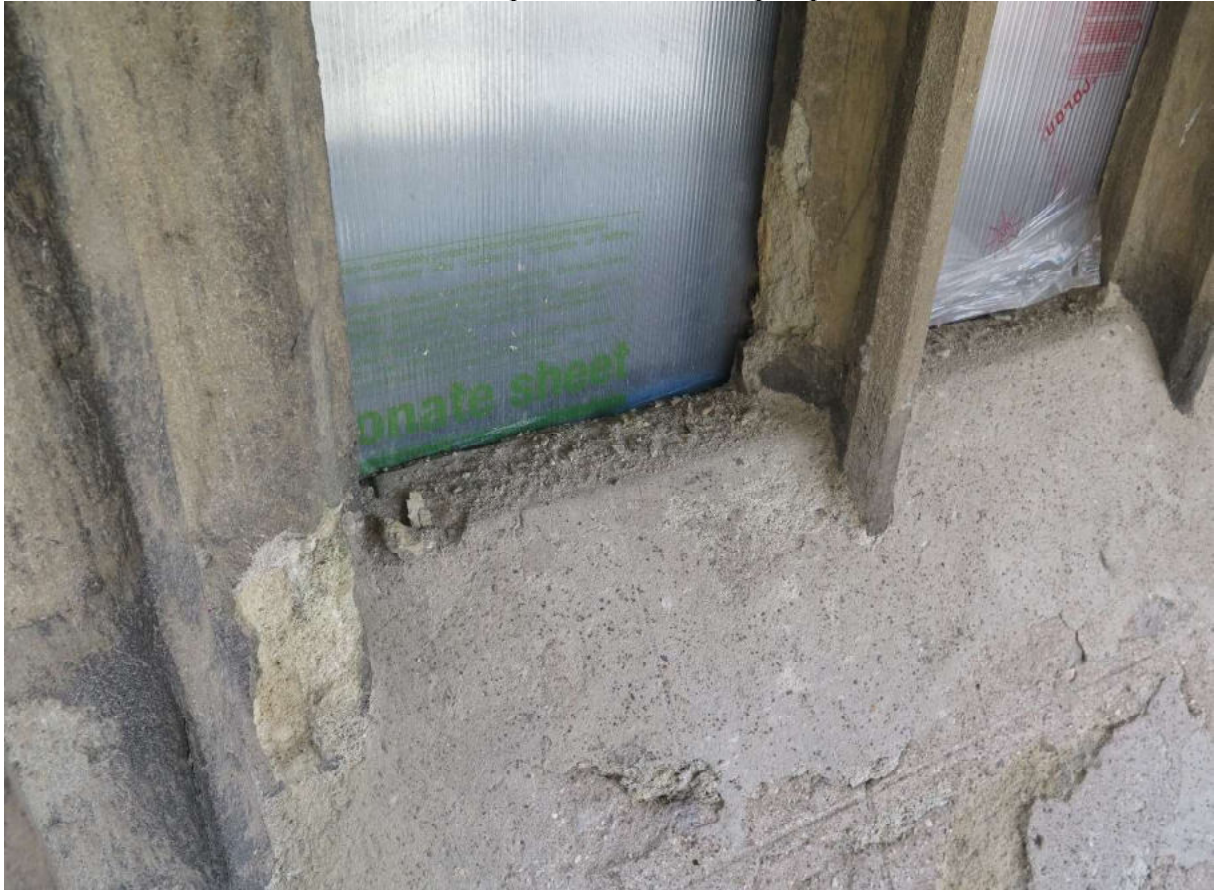
Poškozená spodní část ostění a parapetu
