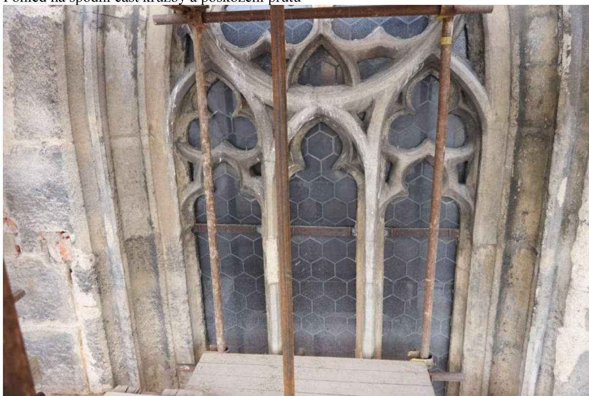
Pohled na spodní část kružby a poškození prutů
