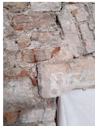
Foto č. 4 – překlad nad okny
